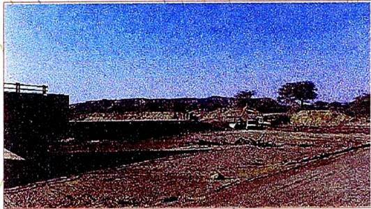
Se produjo erosión longitudinal. Posteriormente, el tramo fue arrasado por completo, se destruyó la estructura del terraplén (Acceso Norte).
