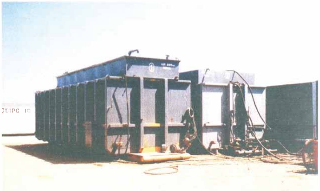
Foto I.17. Tanques de diesel.
