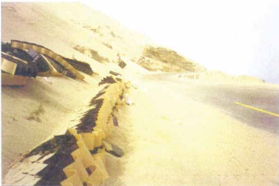
Vista 7.11.- Km. 731. Inclinación posterior del muro de confinamiento
