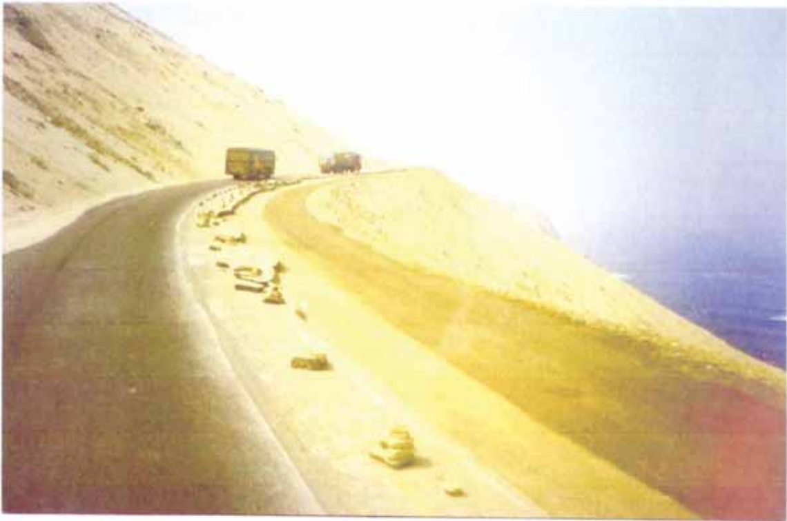
Vista 7.03.- Km. 728+00 al km. 729. Falla en la berma exterior y parte de la estructura del pavimento
