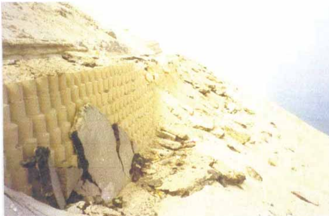
Vista 7.14.- Km. 731. Muro de confinamiento en el talud en el talud exterior con fallas en la carpeta asfáltica
