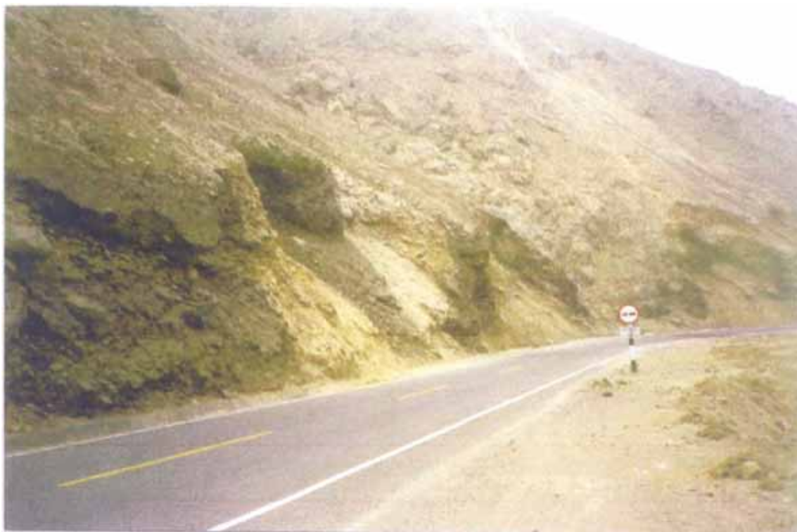
Vista 7.05.- Km. 716. Impregnación asfáltica en talud de agregado grueso conserva su consistencia después del sismo
