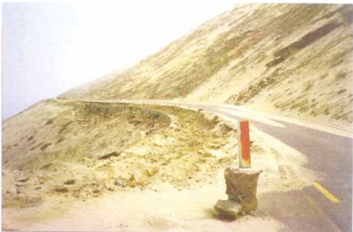
Vista 7.04.- Km. 729+900. Falla de un carril en la estructura del pavimento por asentamientos
