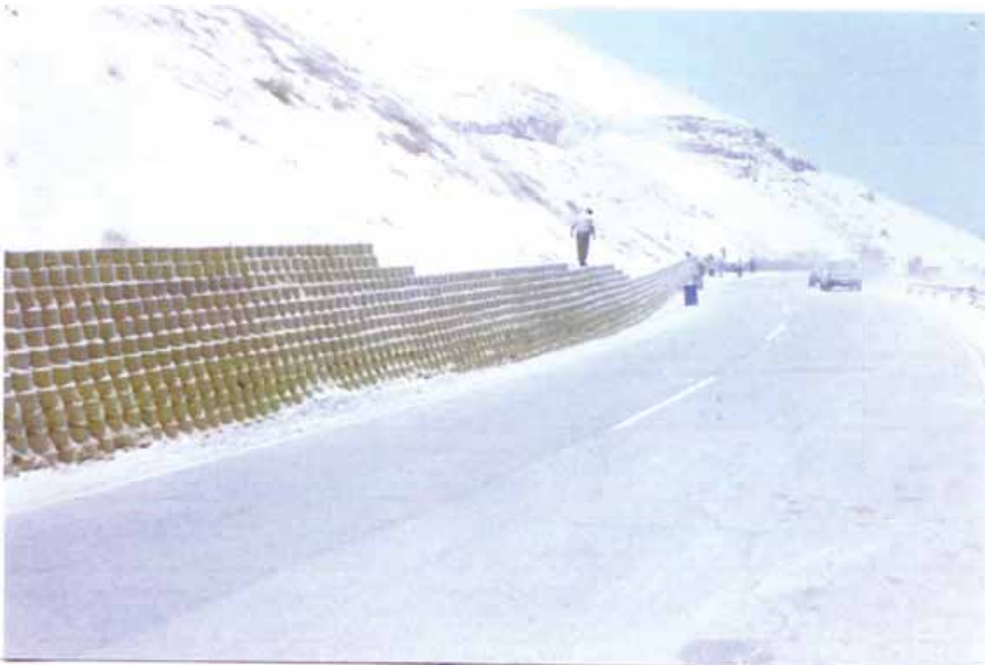
Vista 6.24.- Perfil final del muro de confinamiento celular en el talud interior
