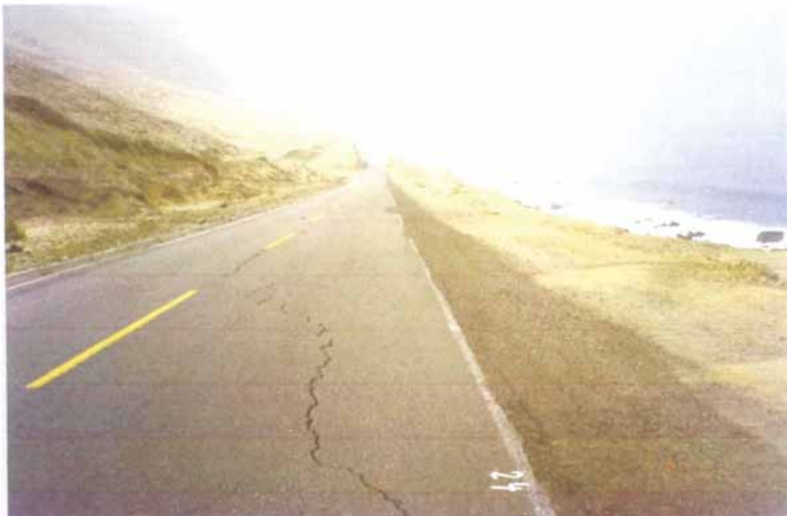
Vista 7.02.- Km. 719+240. Falla en el pavimento con una grieta longitudinal de 1 a 2 cm
