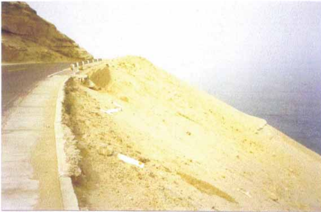
Vista 7.13.- Km. 727. Muro de confinamiento en el talud en el talud exterior en perfectas condiciones
