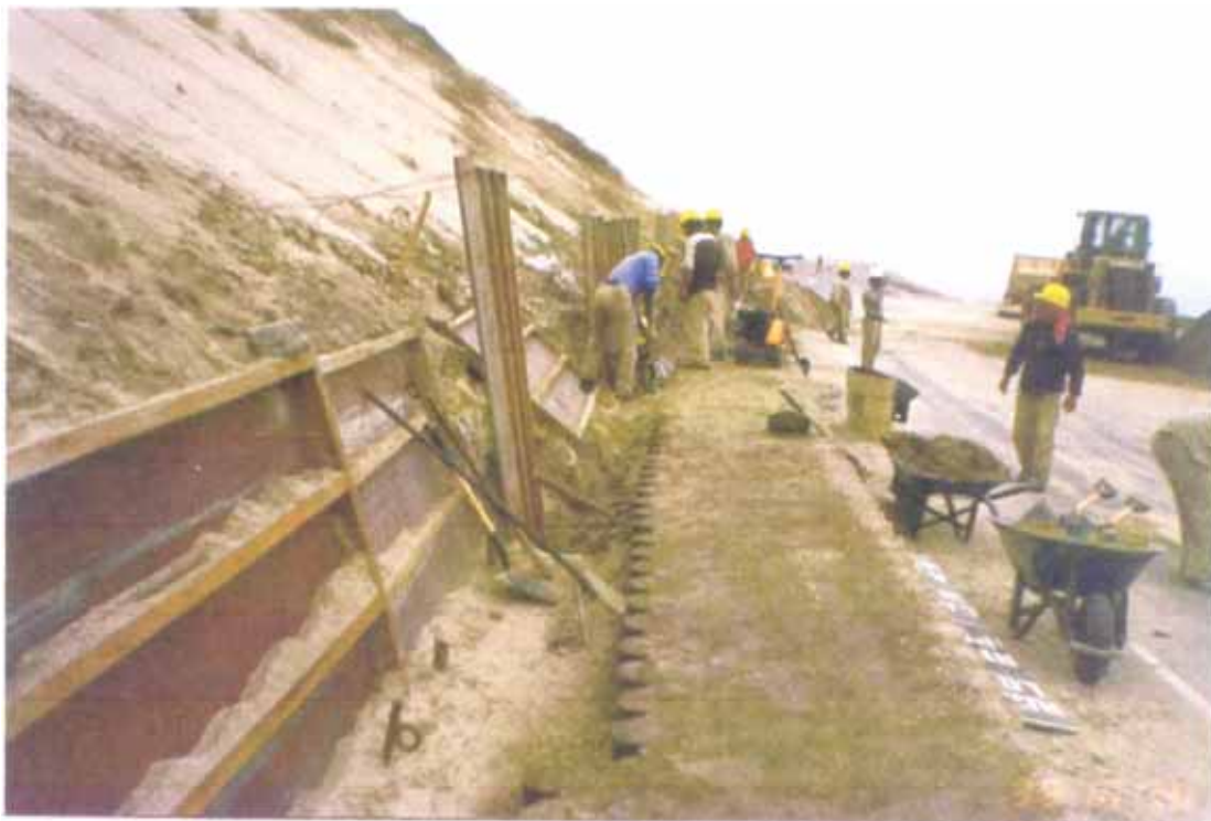
Vista 6.15.- Contención de la arena con paneles anclados mediante costales de arena al talud
