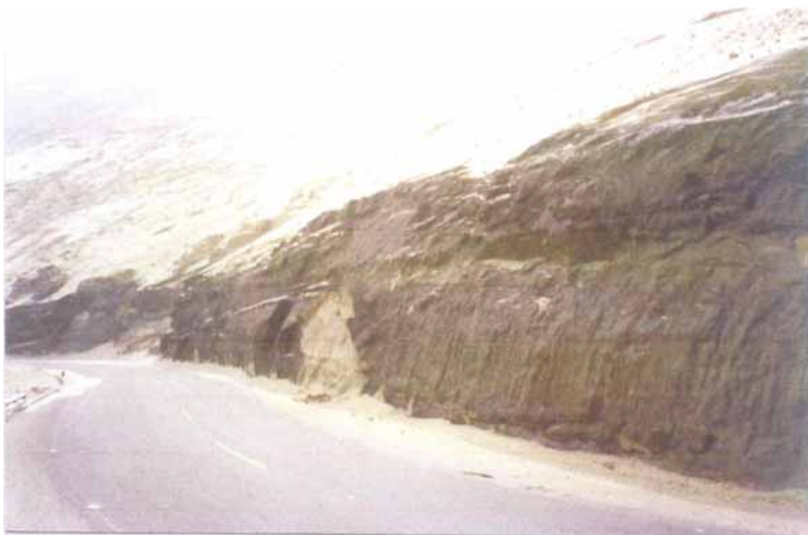
Vista 7.06.- Km. 729+900. Pequeña falla en la Impregnación asfáltica
