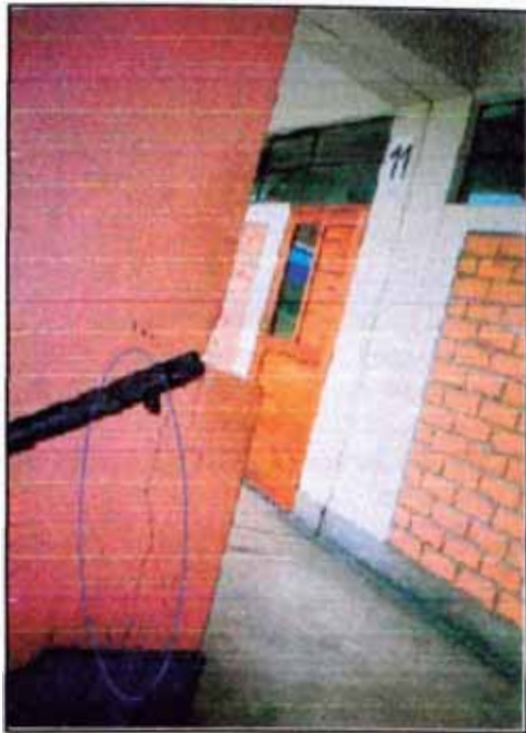
Figura 5.27a, irregularidad estructural, separación insuficiente (C. E. Micaela Bastidas)
