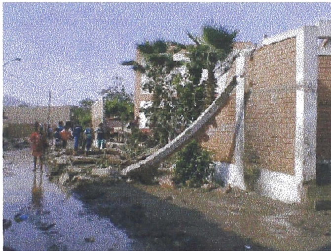
Foto 2. Falla del muro de colegio
