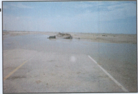
Km.820+700, Erosión general de 250 m de vía (corte), las aguas de la quebrada EL SARCO I, han causado la destrucción de la carretera.
