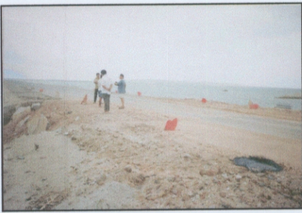
Km.885+800, Erosión general de 180 m de vía (corte), causado por las aguas del río Cascajal que confluyen en este sector (lago La Niña). se observa el trabajo emergencia de relleno.
