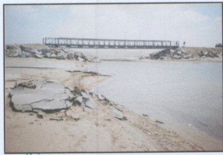
Km.822+500, las aguas de la quebrada EL SARCO II, han causado la erosión general de la vía (corte de 60m). Se observa la colocación de un puente bailey.
