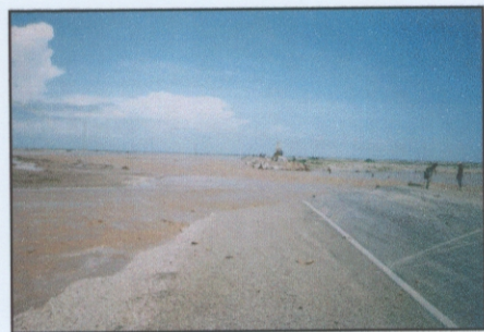
Km.813+840, Rotura de 180 m de vía, las aguas desviadas del río Motupe y La Leche han causado por erosión general, la destrucción de la carretera.
