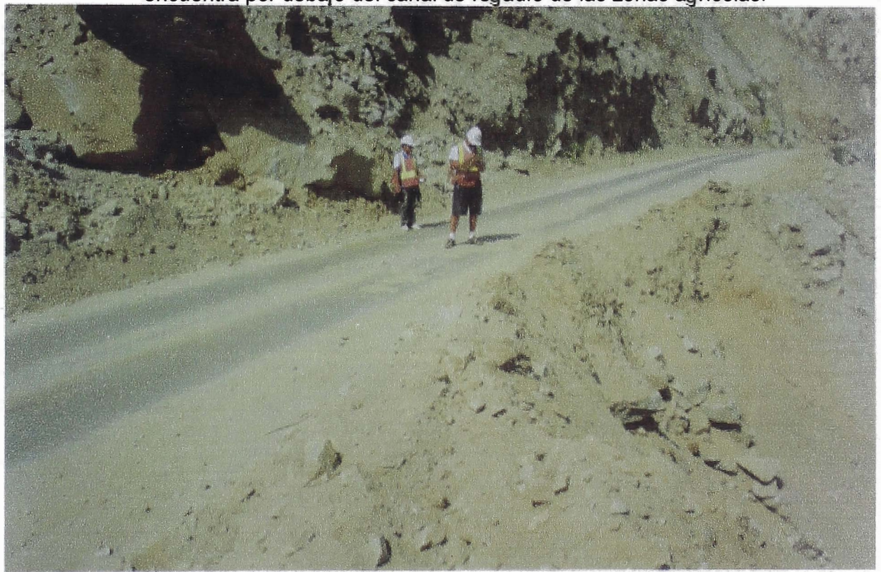
FOTO N° 12 Reducción de la sección de la Vía debido al colapso del terraplén debido al huayco, producto de un mal calculo de estabilidad de taludes.
