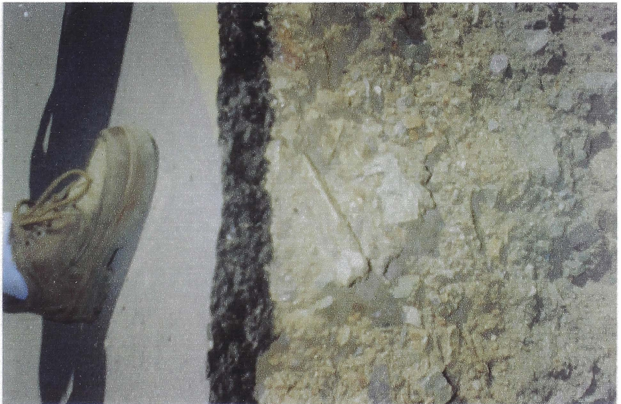
FOTO N° 28 Sección del pavimento nótese claramente las capas y el delgado espesor de la carpeta asfáltica.
