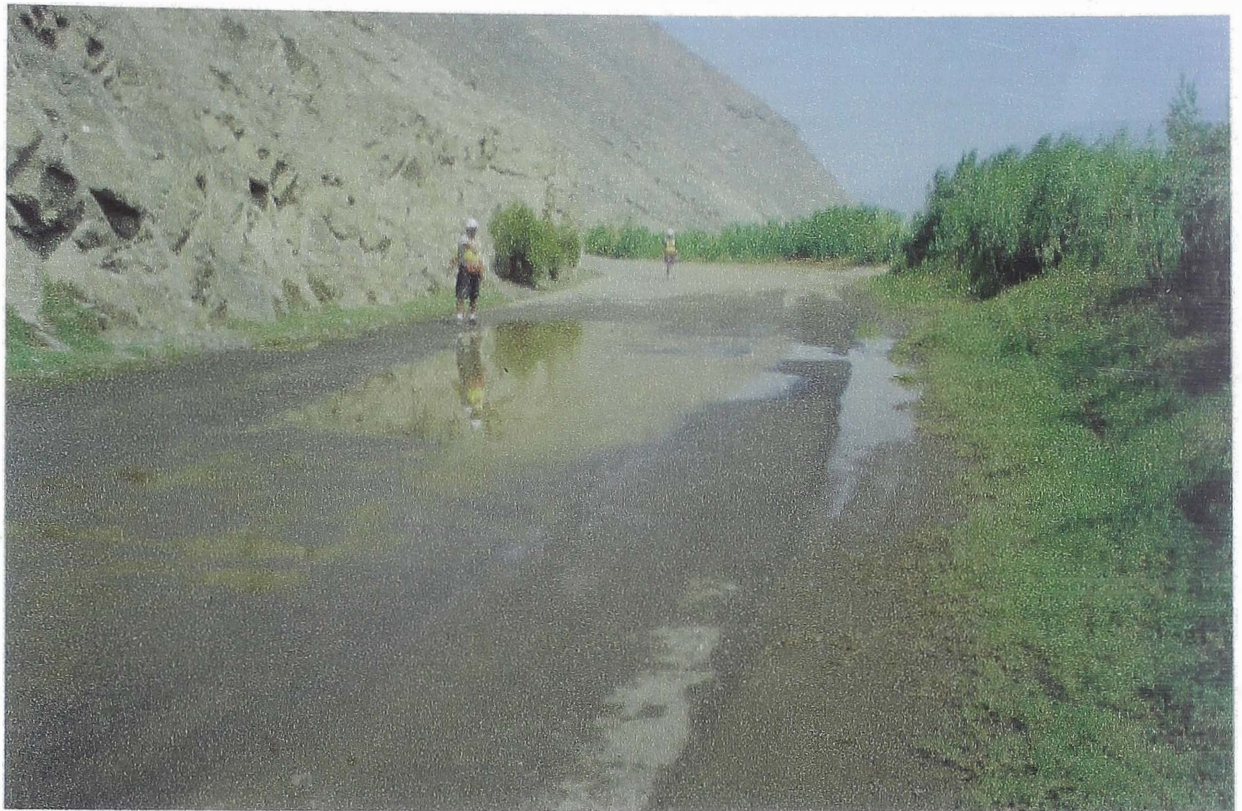
FOTO N° 11 Tramo de vía inundado, debido a que la rasante del Pavimento se encuentra por debajo del canal de riego de las zonas agrícolas.
