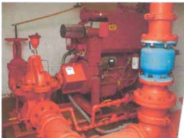
Figura 3.4 Bomba Contra Incendios
