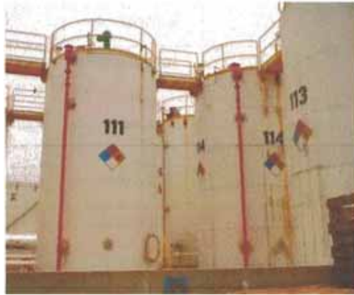
Figura 3.1 Almacén a granel – tanques
