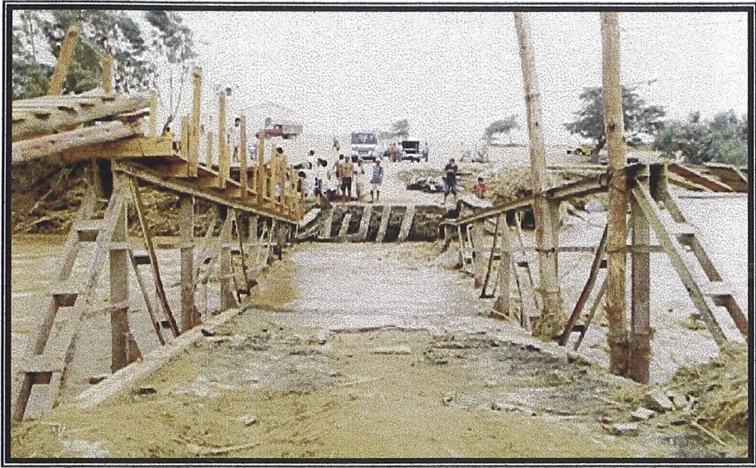
FOTO N° 17: Distrito de ocucaje. Puente destruido por el evento de Enero de 1998
