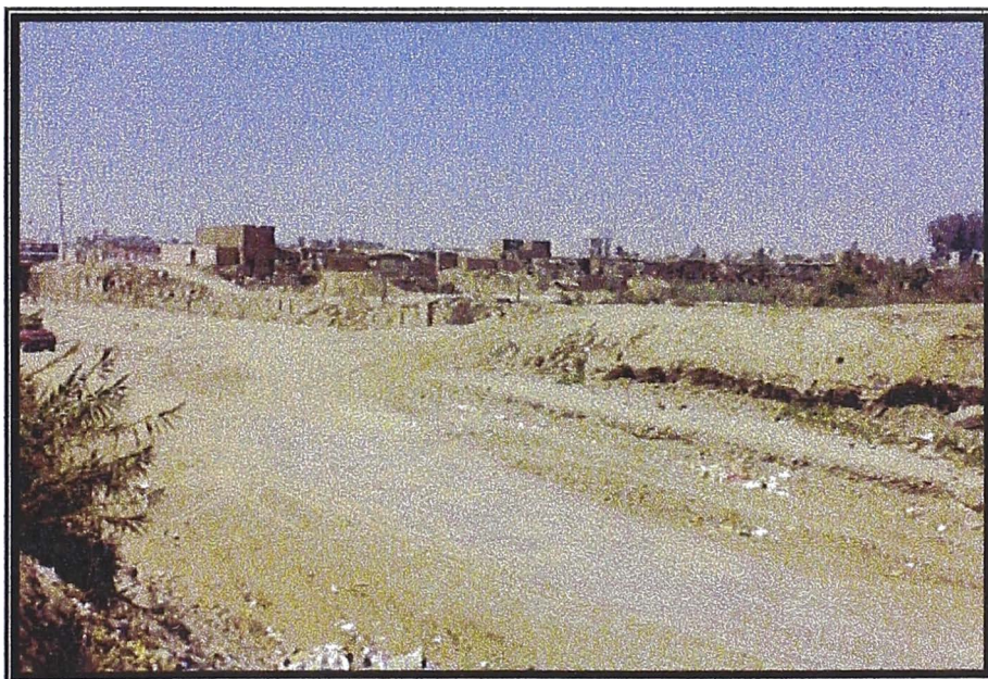
FOTO N° 22: Dique Socorro. Viviendas construidas en el dique que falló en Enero de 1998.
