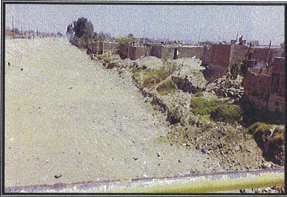
FOTO N° 25: Cauce del río. Margen derecha invadida por viviendas que están completamente desprotegidos
