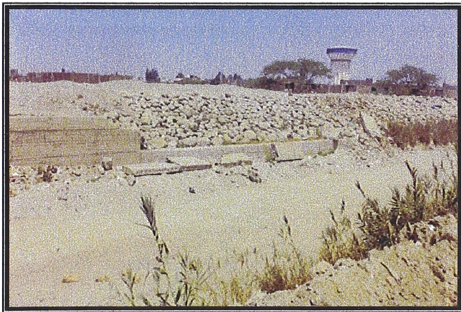
FOTO N° 26: Cauce del río. Defensa ribereña colapsada después del evento de 1998.
