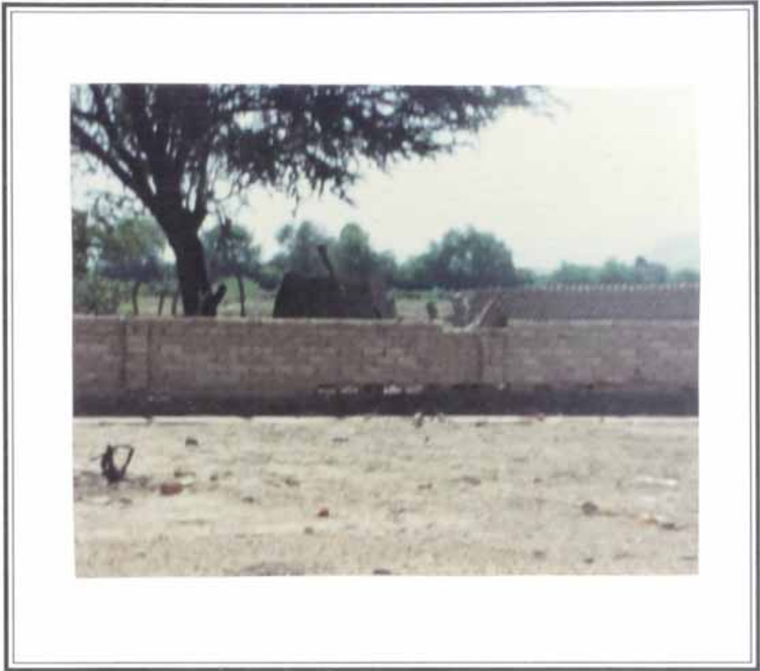
Foto 12.- Deterioro del Zócalo del Muro por el nivel freático.
