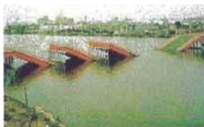
Foto N° 4 : Colapso del puente Showa por desplazamiento lateral. Niigata, 1964.
