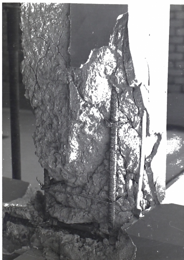
Foto No 16 COLEGIO PIO XII. DEFICIENCIA DE ESTRIBOS EN LAS UNIONES.
