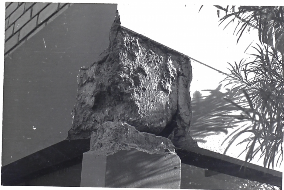
Foto No 20: DETALLE DE LA FOTO No 19,NOTE QUE LA FALLA HA OCURRIDO EN LA JUNTA DE CONSTRUCCION.
