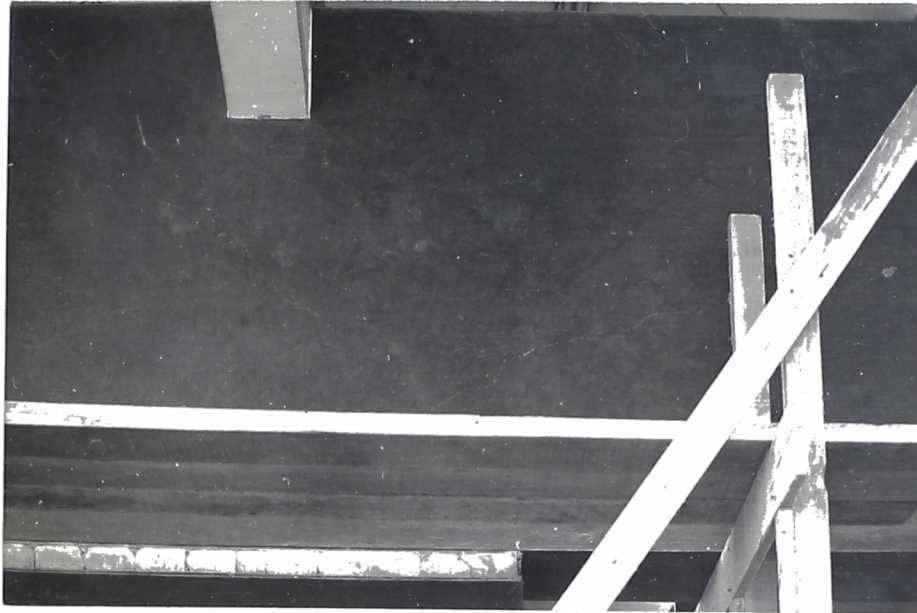
Foto No 9 : GRIETA EN VIGA PRINCIPAL.
