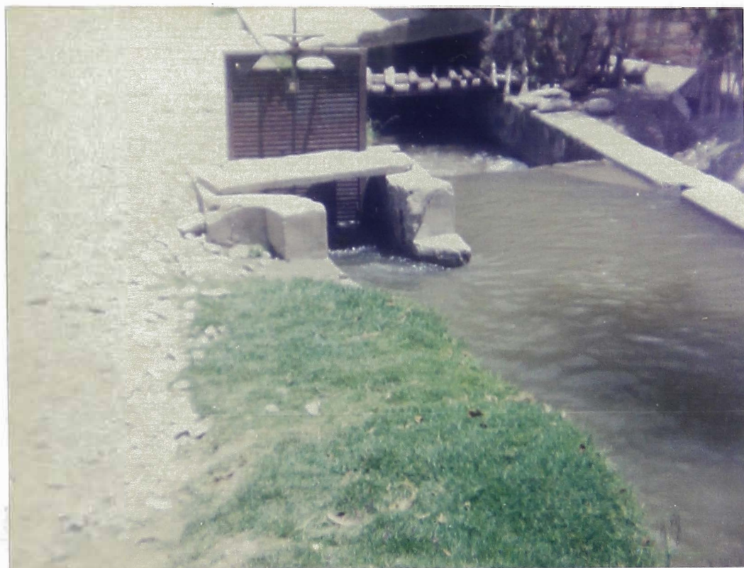
FOTO N o 08.- Vista de la captación de agua el cual es llevado hasta la planta de tratamiento de vilcacoto por un canal, el agua proviene de las lagunas y abastece a la ciudad de Huancayo.
