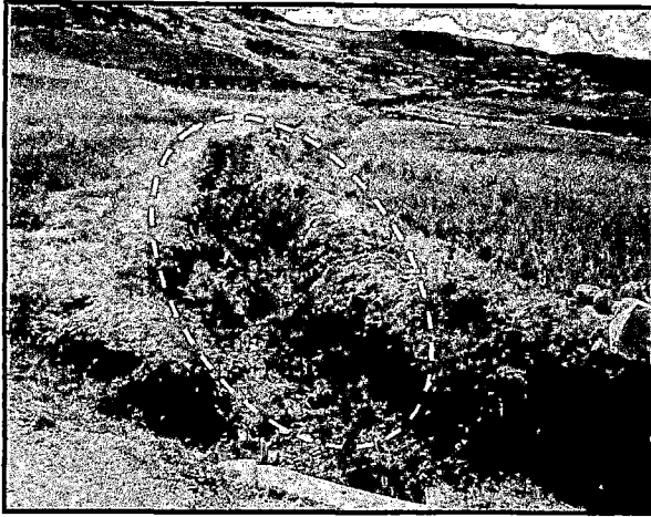
FOTO N° 4.43: Canal de tierra ubicado en le barrio de Azapampa. Apréciase el estado de abandono en que se encuentra.
