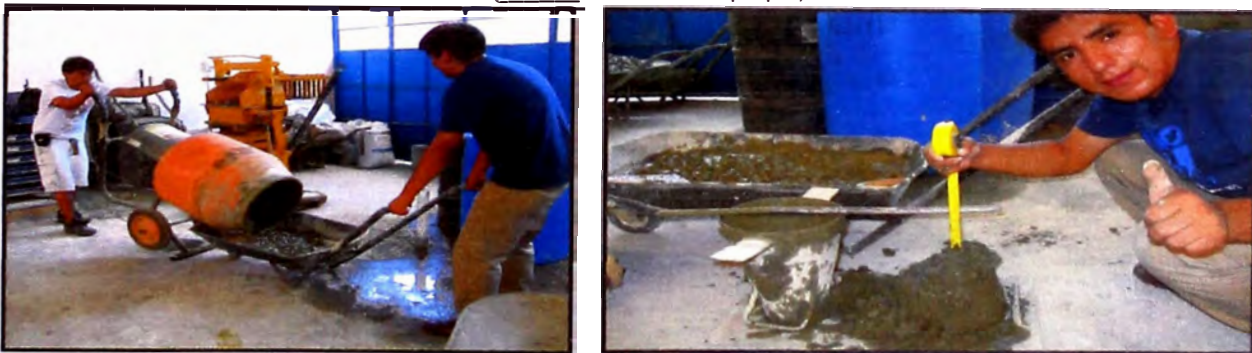
Figura 2.- Aquí se tiene la mezcla de concreto luego de haber estado en el trompito, para hacer la prueba del asentamiento del concreto con Cono de Abrams (slump) que tiene el concreto.
