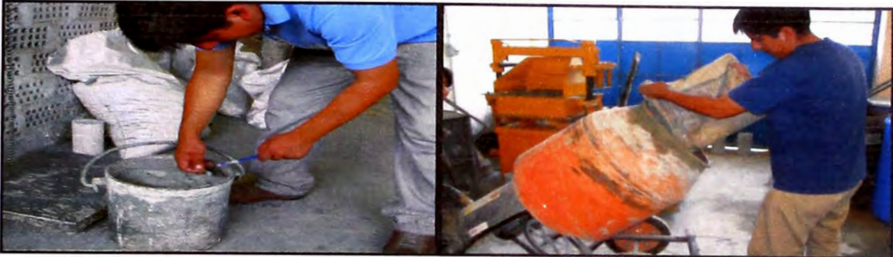
Figura 1.- Se realiza el pesado de cada uno de los componentes del concreto, se procede a llenar los componentes a la mezcladora de concreto.
