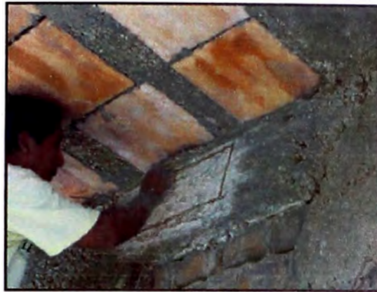
Figura 20. – Preparación de la superficie de la viga V1 para ser ensayada. (Fuente: Elaboración propia)
