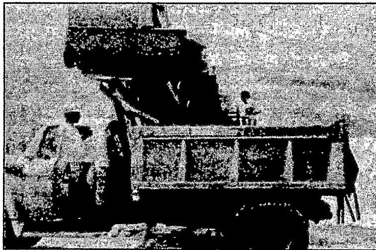
Figura 7.2: Transporte de la mezcla a la calzada usada en el Tramo Carretero de la Ciudad Alemán a Río Tesechoacán, perteneciente a la Carretera La Tinaja – Sayula (México).
