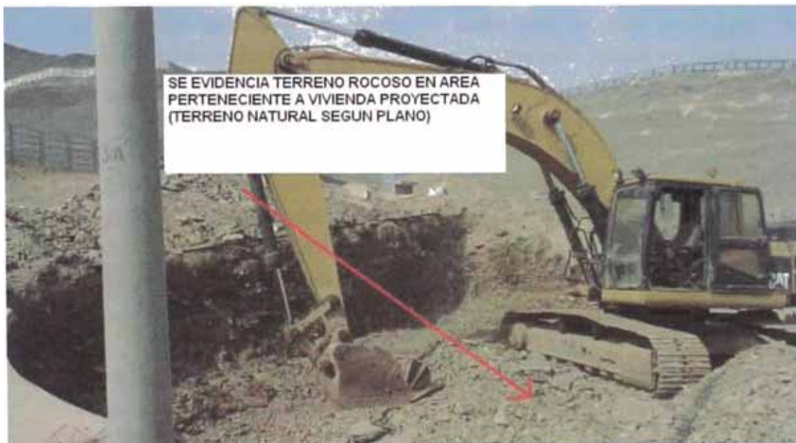
Figura 3.8: Presencia de terreno rocoso en el perteneciente a una de la viviendas proyectadas en la Mz. Q – lote 14 en Villa Club 05.
