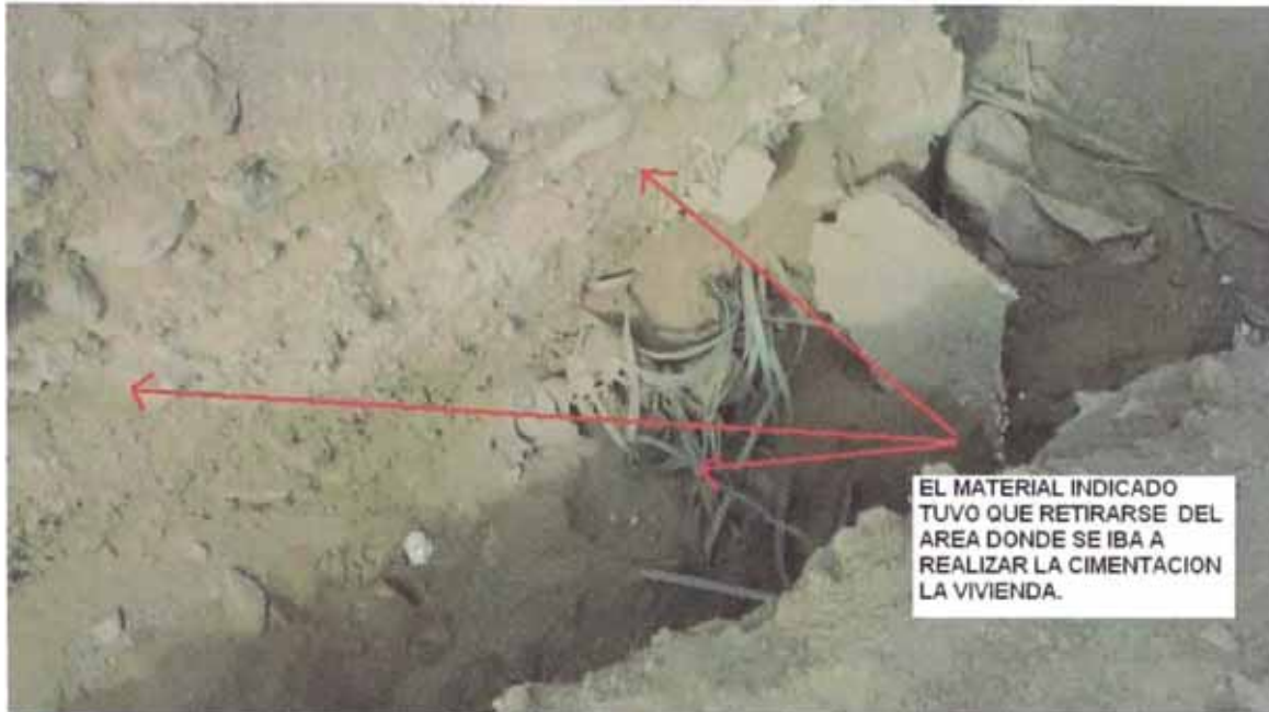
Figura 3.9: Material inadecuado que se presente en la zona de cimentación perteneciente a uno de los lotes pertenecientes Villa Club 05 ( Mz. D –02).
