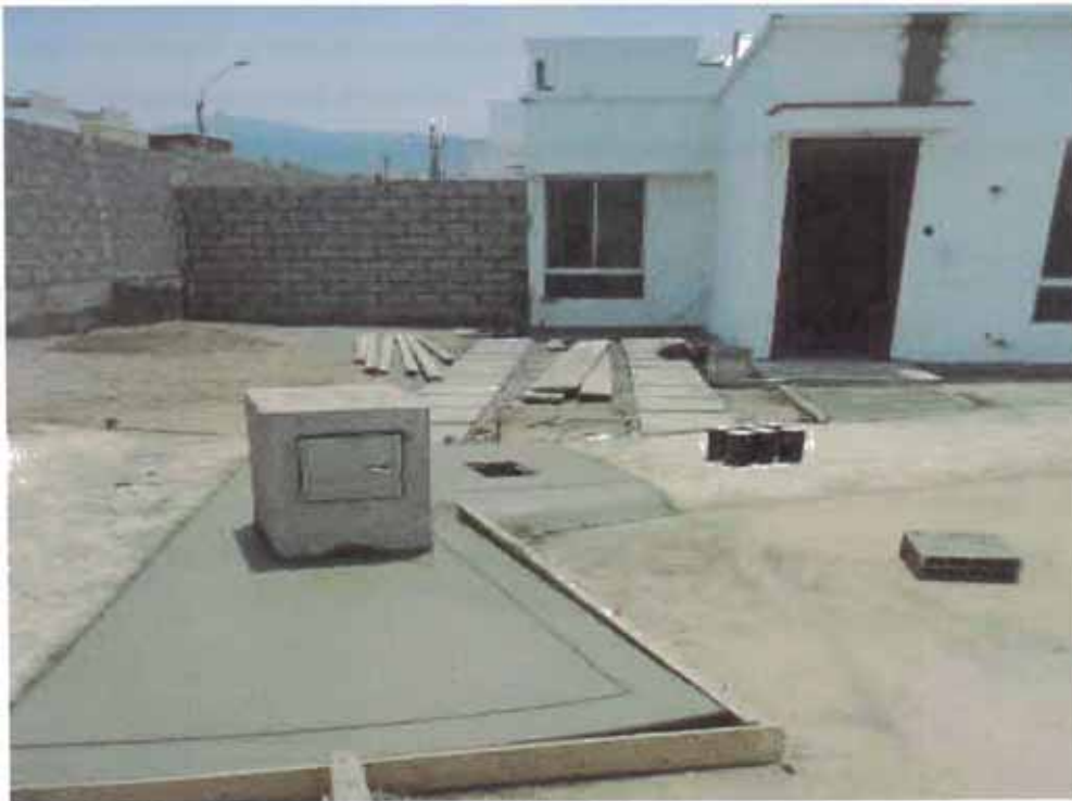
Figura 3.1: Martillo de vereda construida en calle que se encuentra ubicada en zona de ingreso a estacionamiento vehicular.
