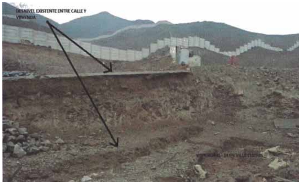
Figura 3.10: Muestra desniveles existentes no tomados en cuenta en el proyecto (entre los niveles de las calles en Villa Club 05).
