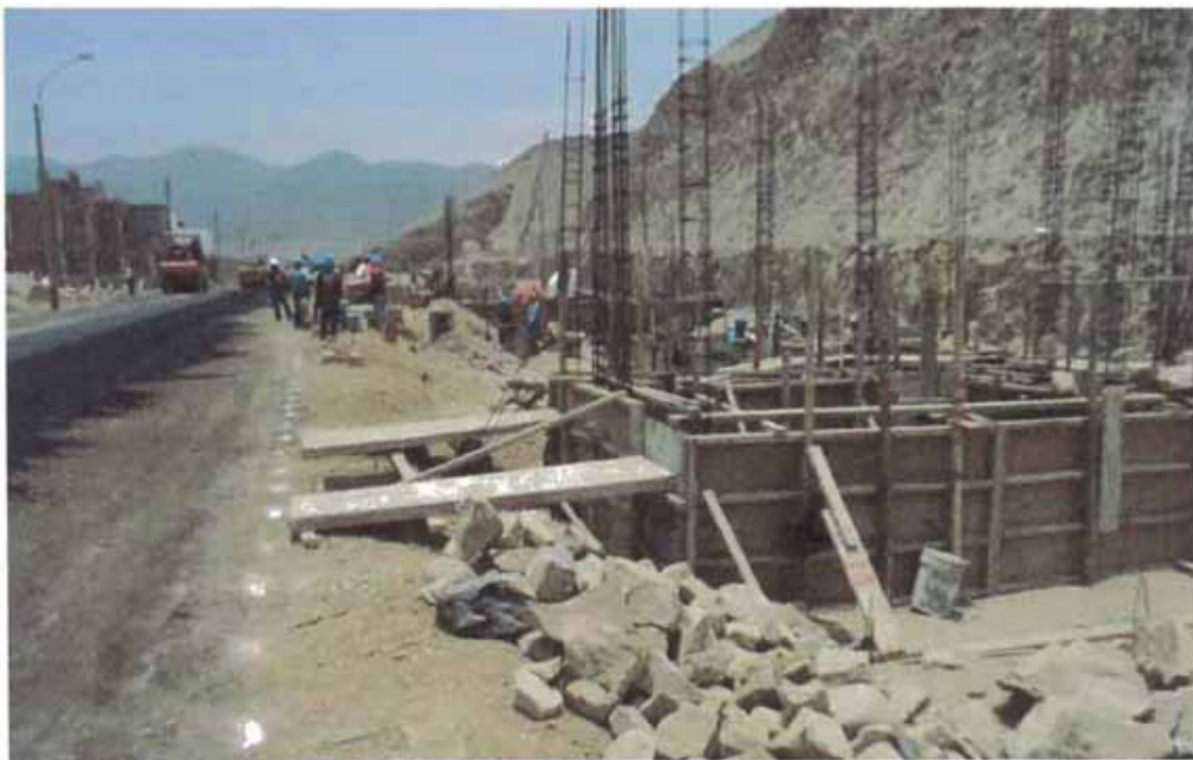
Figura 3.16: Ejecución del asfaltado y la construcción de viviendas en una misma calle y al mismo tiempo, generando pérdidas (tiempo, costo, etc.).(Fuente propia).
