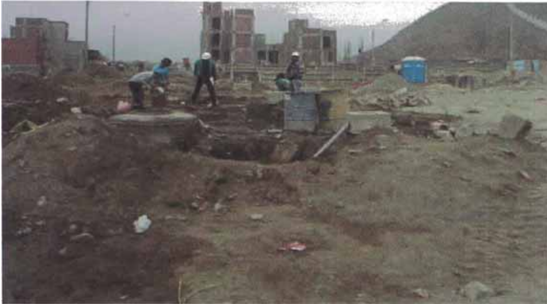
Figura 3.15: Accesos bloqueados por las conexiones de agua potable cuya ejecución se encuentra inconclusa.(Fuente propia).
