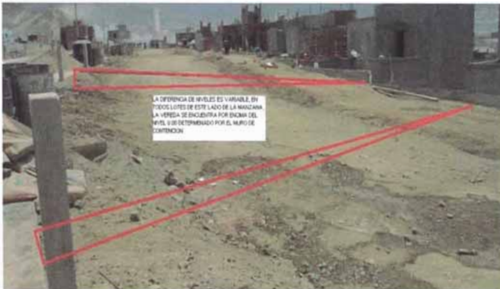
Figura 3.6: Falta de compatibilidad en los niveles referenciales construidos entre las veredas de la calle 04 en Villa Club 05 y el muro de contención construido. (Fuente propia)
