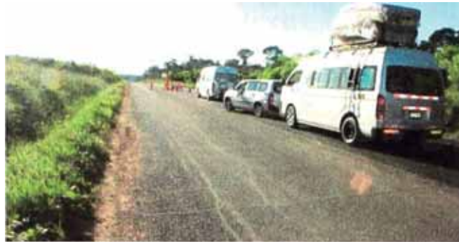
FOTO N° 1.1.- Carretera en mal estado.
