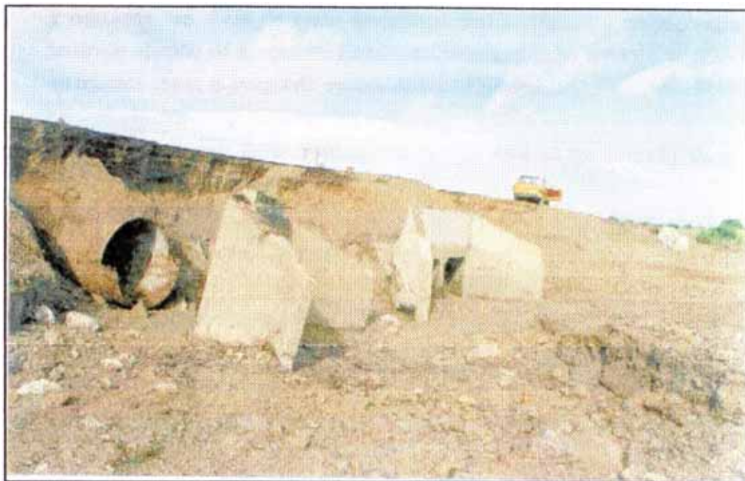
Foto N° 4.1 Erosión local de los aleros de entrada de las alcantarilla. También se produjo el efecto de socavación transversal que afectó al terraplén de la carretera.
