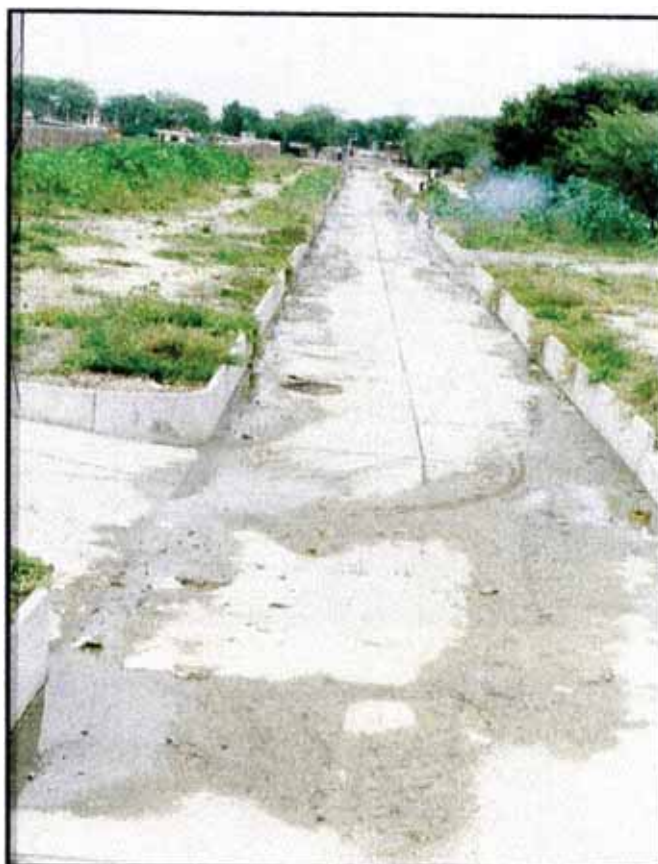
Foto N° 6.1: Dren Petro Perú tramo I, funcionó satisfactoriamente
