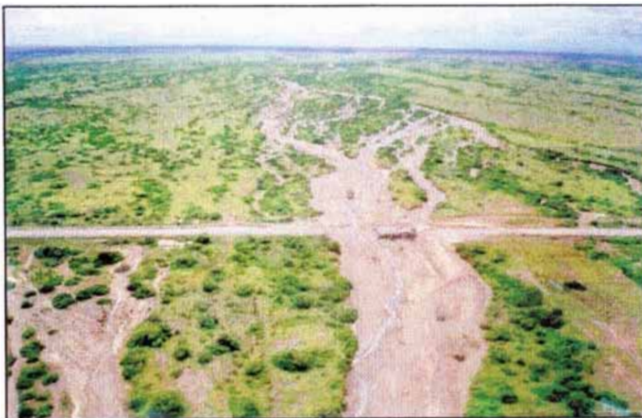
Foto N° 4.6 Erosión general del terraplén: se observa que la estructura de cruce se encuentra colmatada por palizada y la erosión se produjo en el terraplén adyacente (efecto tipo b).
