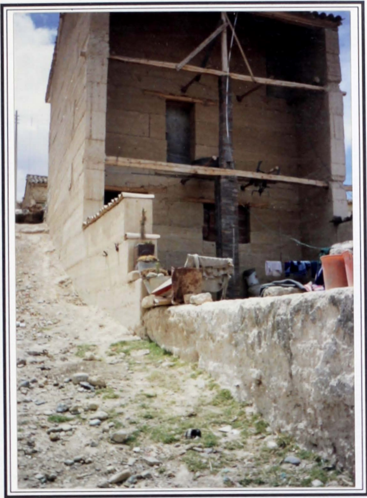
Foto 1: Edificaciones de tapial en el que se observa una columna formada de ladrillos que sirve de apoyo a las vigas de madera que la cruzan y que cumplen la función de arriotre de los muros transversales. Como se ve, no existe un buen confinamiento de los muros, pues estos actúan por peso propio como se diseñaba antiguamente.
