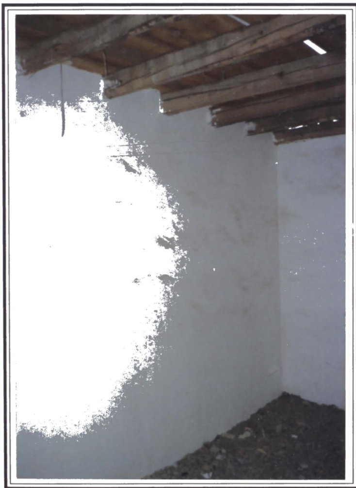
Foto 4: Vista interior de la edificación anterior en el que se observa las vigas de madera que sirven de apoyo al entrepiso de madera, creando una zona de debilidad potencial en el área de influencia de los listones que hacen las veces de viguetas en un techo del tipo aligerado.
