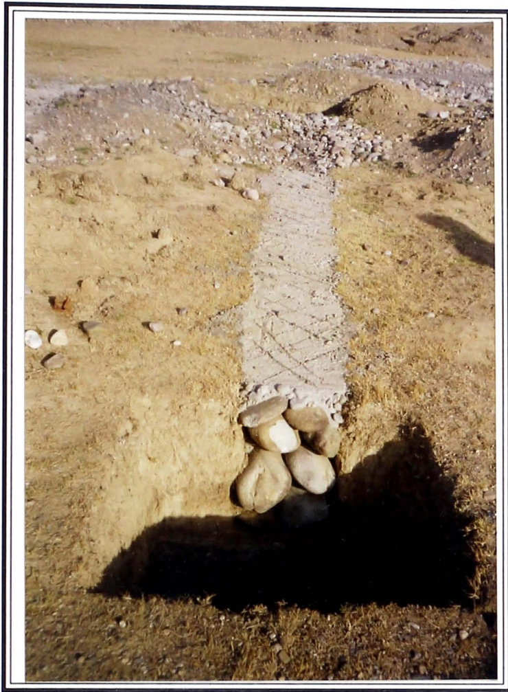
Foto 13: Detalle constructivo de la cimentación en el que se observa que la pasta de cemento no cubre al agregado grueso (piedra grande)
