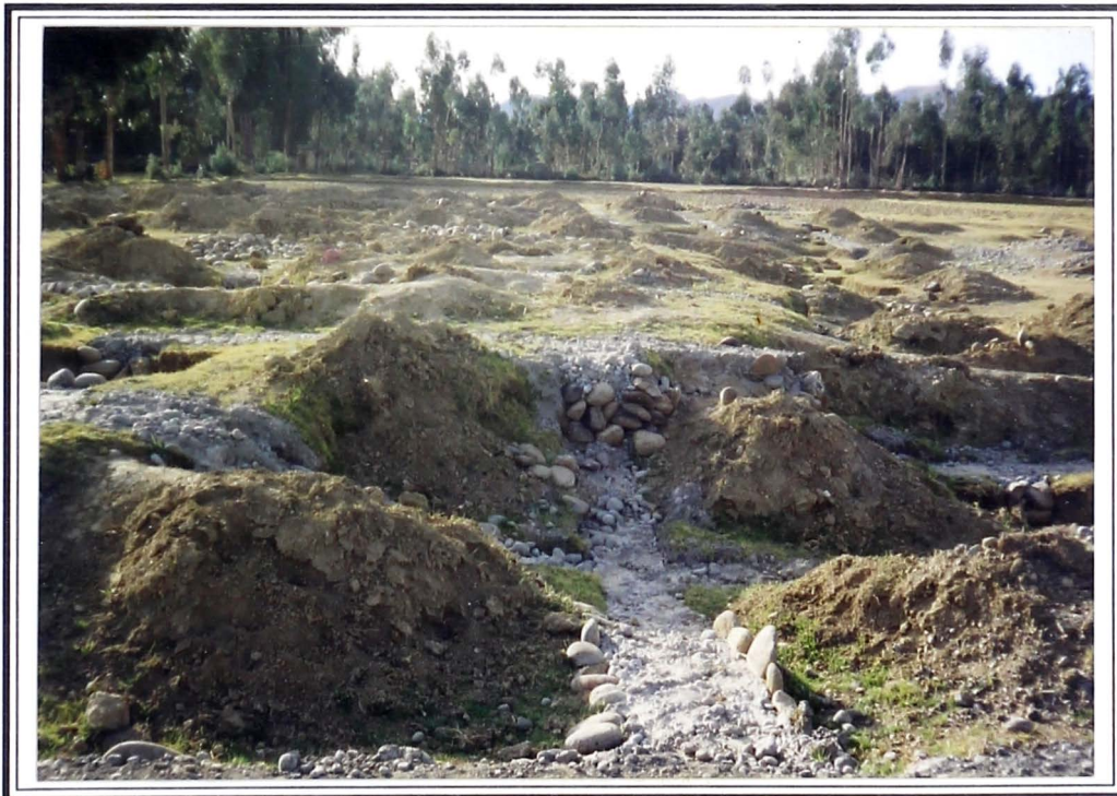
Foto 14: En la vista se observa que el terreno no ha sido nivelado previamente, determinando que la cimentación se presente con desniveles.
