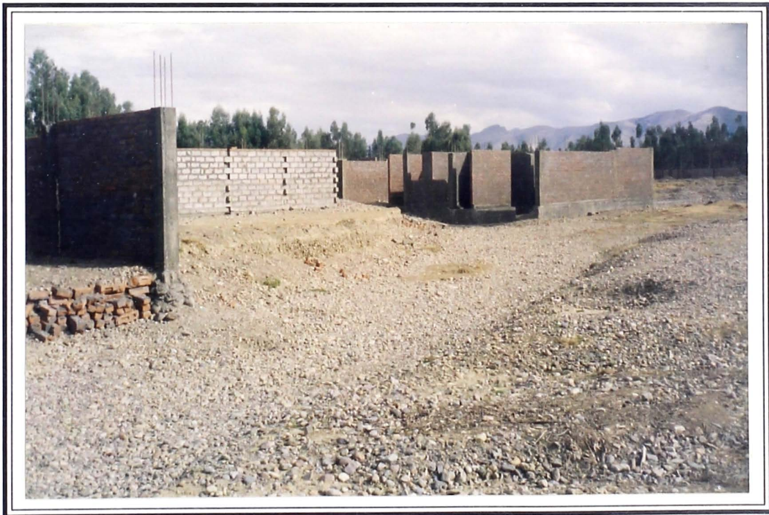
Foto 9: La construcción de las viviendas del Grupo Habitacional que esta proyectado en pleno lecho del río y el cimiento se observa en la vista totalmente descubierto.
