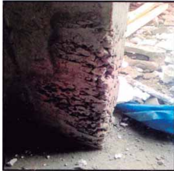
Fig. 2.32 Vista de una cangrejera debido a problemas en el vaciado
