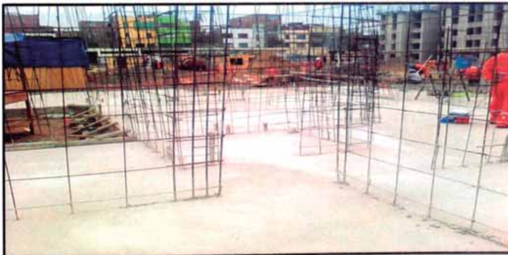
Fig. 2.24 Detalle del acero de refuerzo convencional dúctil del primer nivel, Construcción del Proyecto Parques Garezon, Lima – Perú 2010
