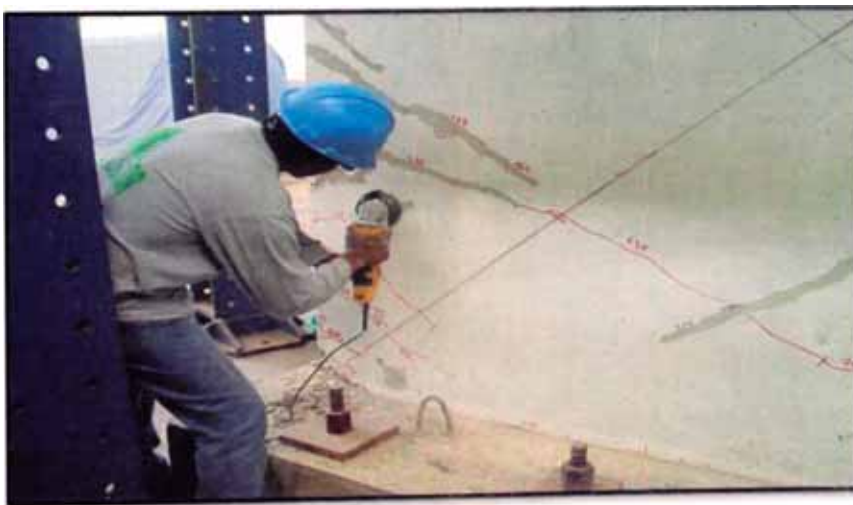
Fig. 3.27 Proceso de identificación de Fisuras
