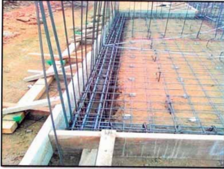
Fig. 2.20 Vista del encofrado en platea de cimentación, Construcción del Proyecto Parques Garezon, Lima – Perú 2010
