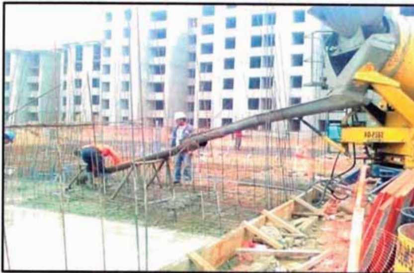
Fig. 2.22 Vista del proceso de vaciado de plateas de cimentación, Construcción del Proyecto Parques Garezon, Lima – Perú 2010
