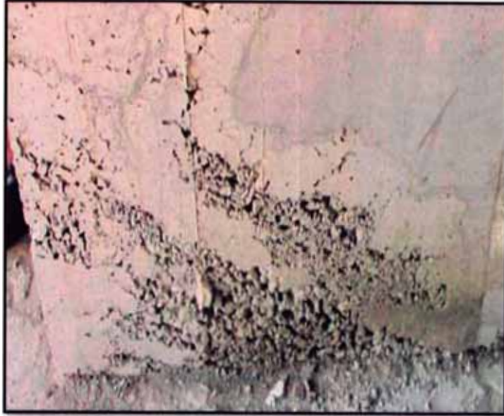
Fig. 2.29 Vista de defectos superficiales debidos a la segregación del concreto
