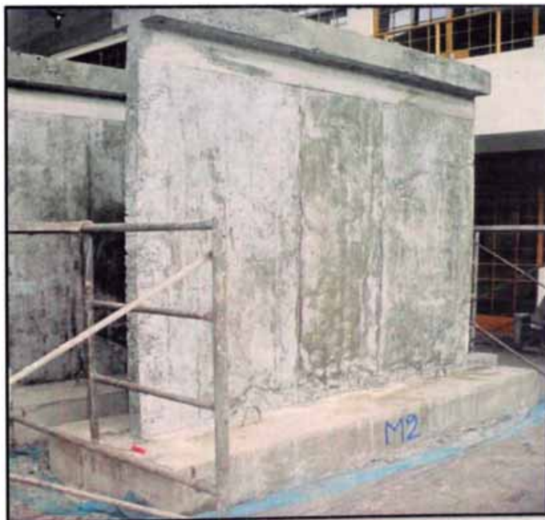
Fig. 3.22 Superficie de concreto luego del desencofrado
