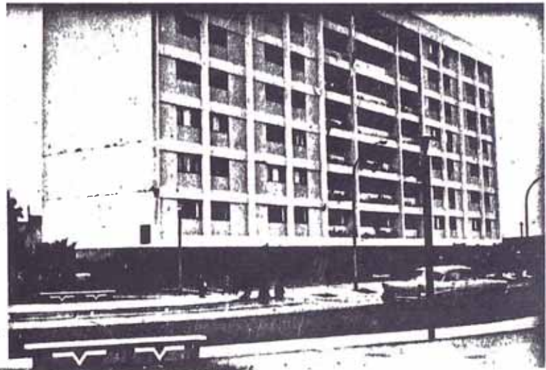
Foto N°2. Edificio de 8 pisos en La Punta a ambos costados y en los niveles 2 y 3 existen rajaduras horizontales debidas posiblemente a la influencia del suelo.
