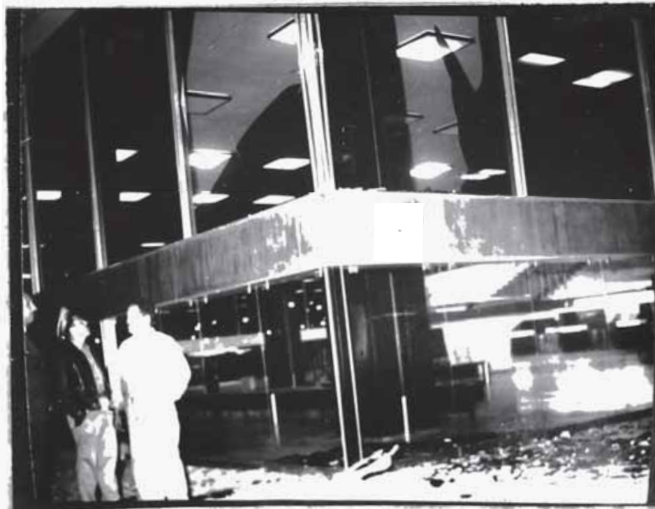
FOTO N°20 Grandes pérdidas ocasionadas por roturas de vidrio.
