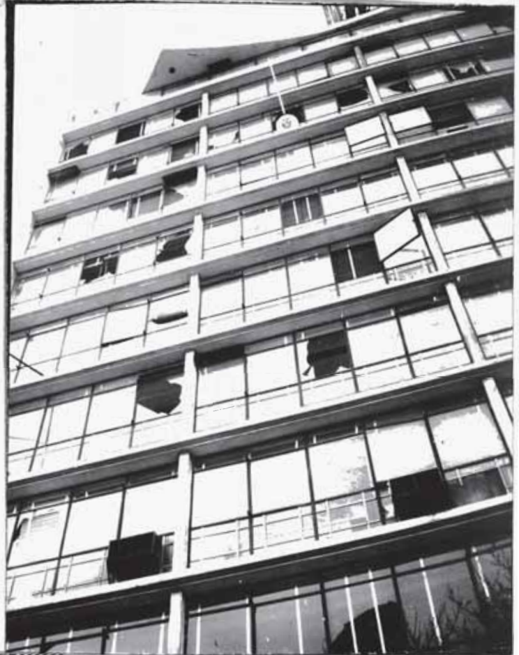
FOTO N°23 Puede verse claramente el peligro que entraña para los transeúntes la rotura de vidrios de edificios altos.
