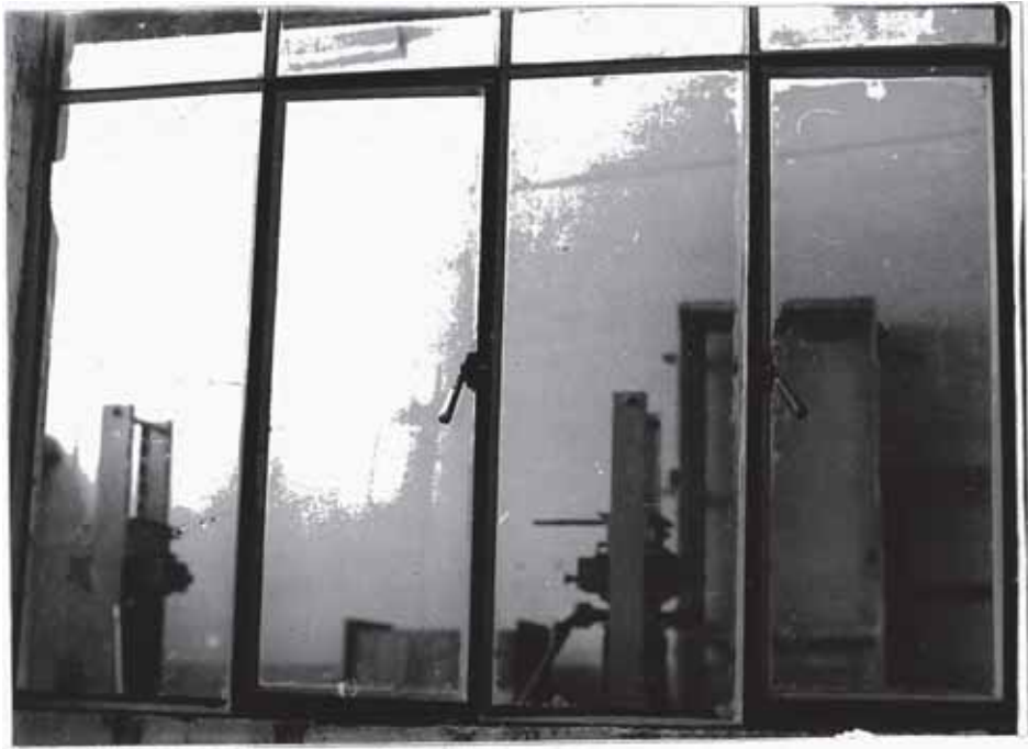
FOTO N° 9 Fracturas de los vidrios en una ventana de fierro
