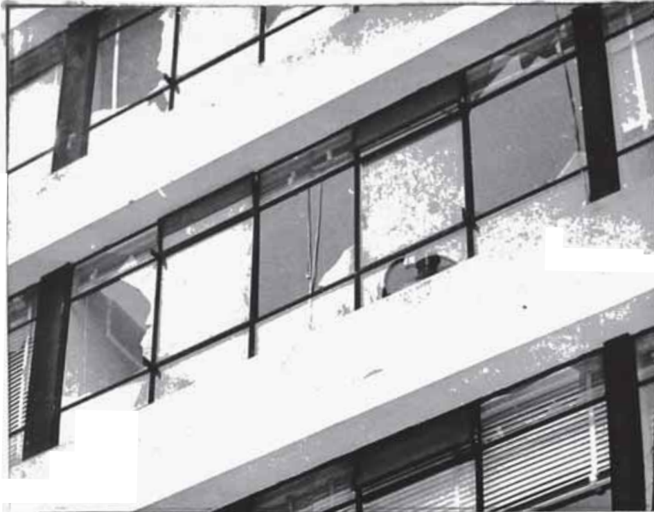
FOTO N°19 Se observa que los paños fijos son los que se fracturaron
