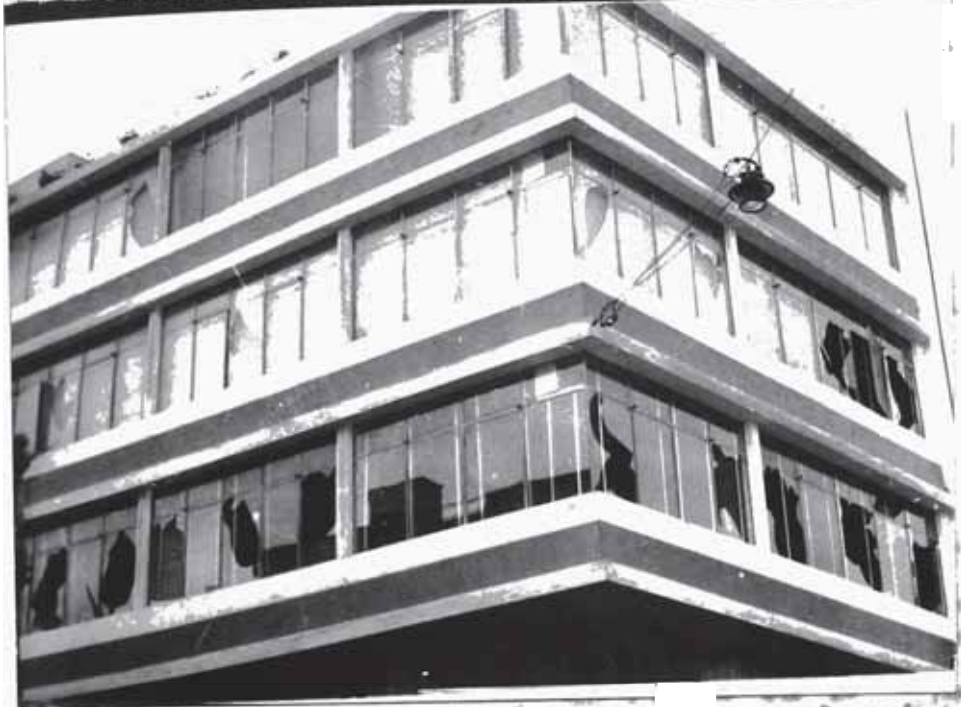
FOTO N°22 Edificio de 4 pisos con un elevado número de vidrios fracturados.
