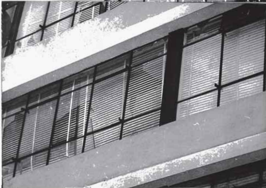
FOTO N°24 Se observa nuevamente que los vidrios fijos son los que se fracturaron.
