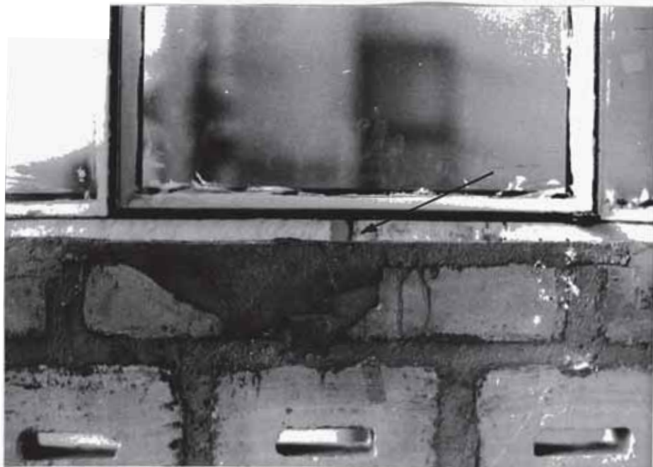
FOTO N° 18 Detalle de la parte inferior de la ventana de fie rro de montaje especial. Se observa que uno de los anclajes se ha desplazado horizontalmente.
