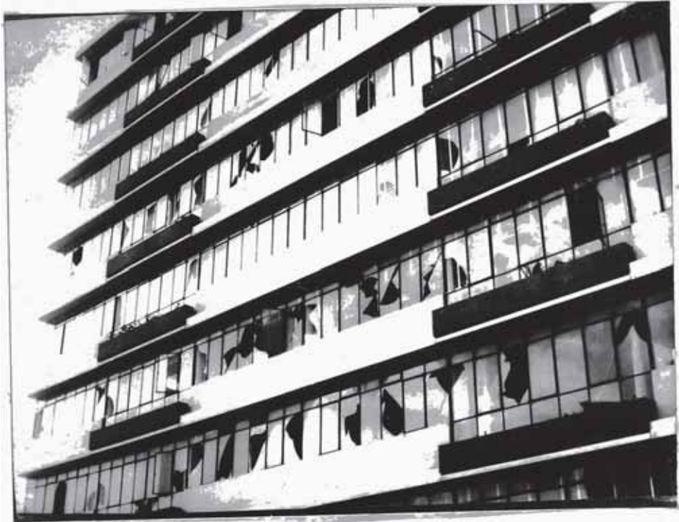
FOTO N°21 Alto porcentaje de rotura de vidrios en edificios de vivienda.
