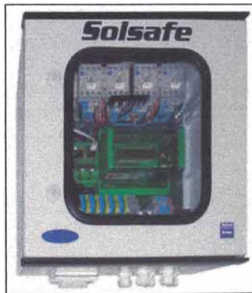
Figura 2-9. Tablero de Transferencia Automática con los accesorios en su interior.
