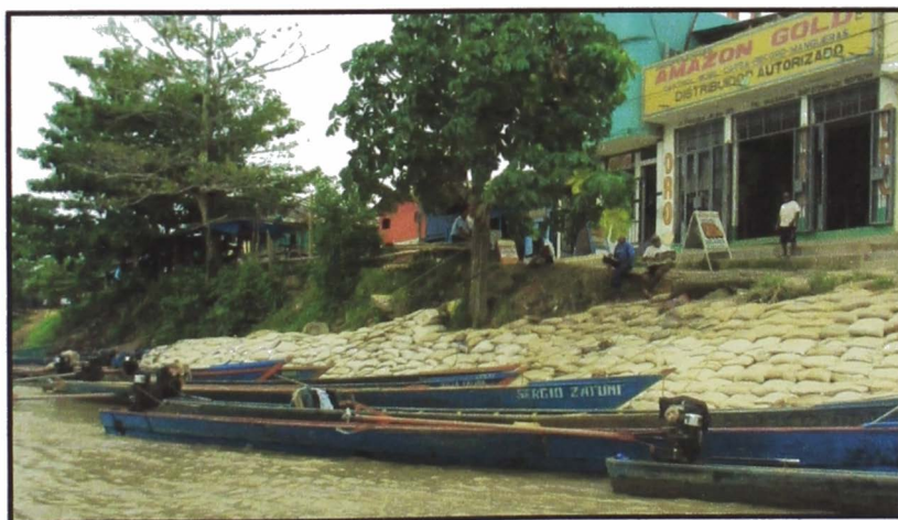
Foto N° D.4. Zona III, Malecón, Puerto Rosario de laberinto, se observan los sacos de polipropileno con arena, para disminuir la erosión.
