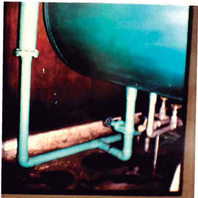
PÉRDIDA DE AGUA POR TUBERÍA DE PURGA DE TANQUE HIDRONEUMÁTICO. LA VÁLVULA DE CONTROL TIENE DETERIORADA LA EMPAQUETADURA FOTO 6
