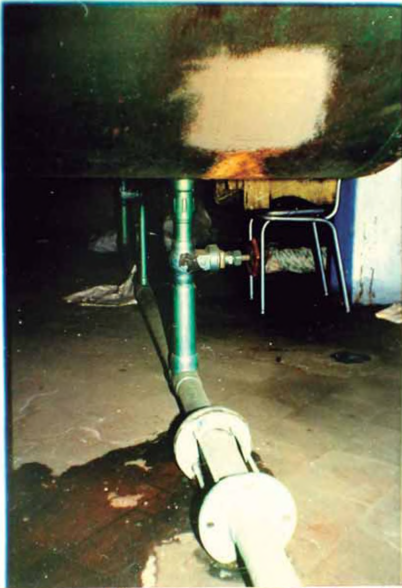
TANQUE HIDRONEUMÁTICO CON SERIO DESGASTE EN SU PLANCHA DE FIERRO ROLADO
