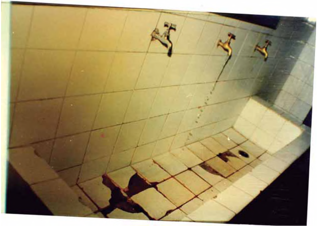
LAVADERO DETERIORADO EN SERVICIOS HIGIÉNICOS VARONES PERDIDA DE AGUA POR DESGASTE DE EMPAQUETADURA EN VÁLVULAS
