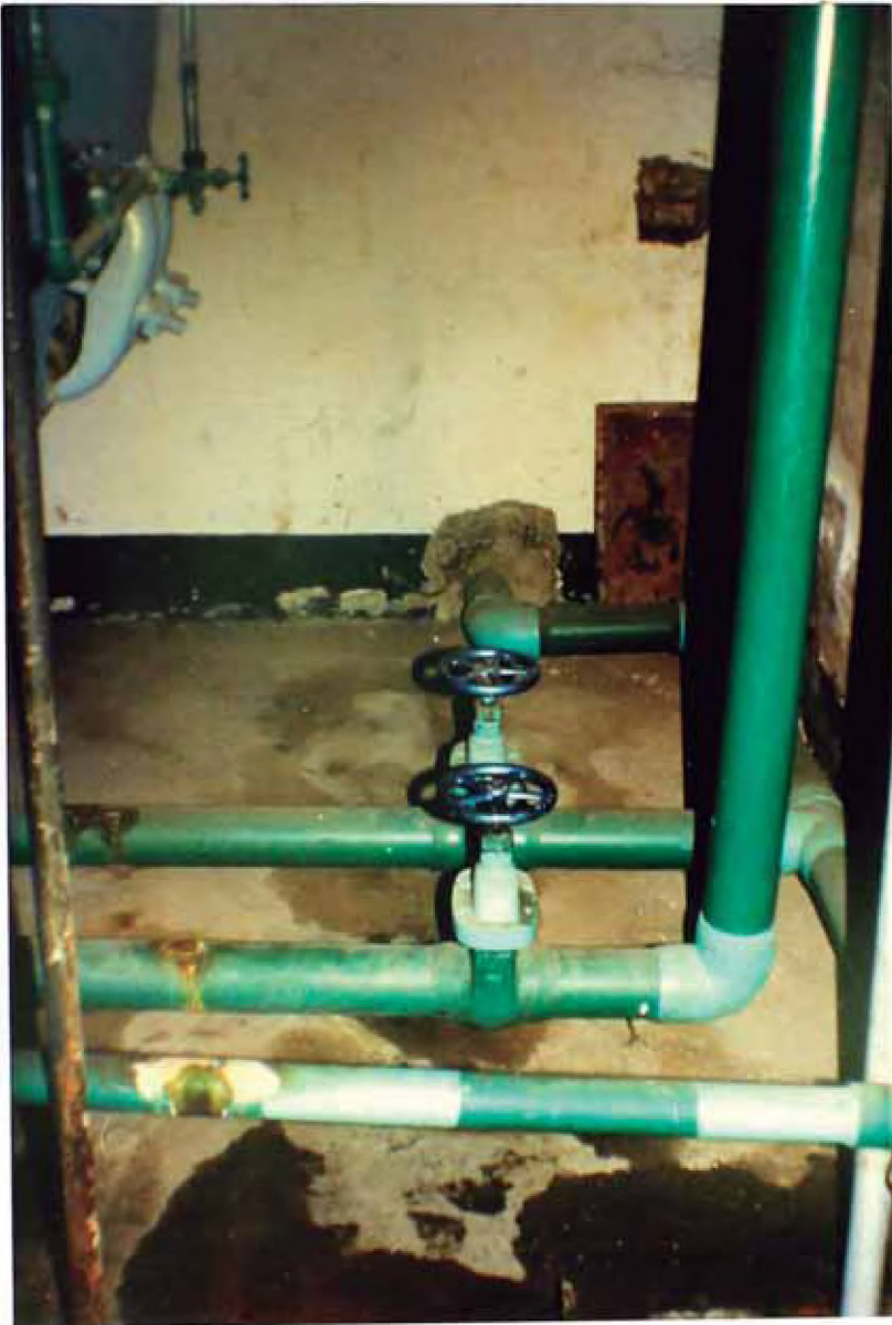
LLAVES DE CONTROL DE NIVEL EN TANQUE HIDRONEUMÁTICO, CON FUGA DE AGUA, OCASIONANDO CORROSIÓN EN TUBERÍAS DE PRESURIZACIÓN
