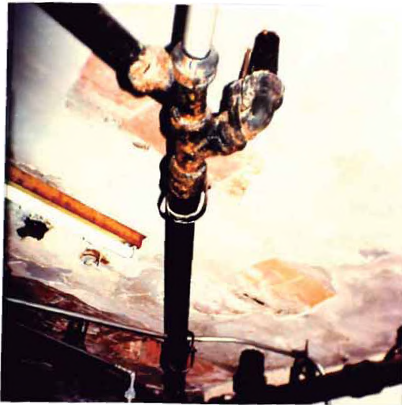
EMPALME DE EMERGENCIA CON TUBERÍA PARA DESAGUE PVC, POR COLAPSO DE TUBERÍA DE F°F° FALTA SOPORTE DE TUBERÍA INEXISTENCIA DE PASES DE TUBERÍA EN LOSA O TECHO FOTO 22
