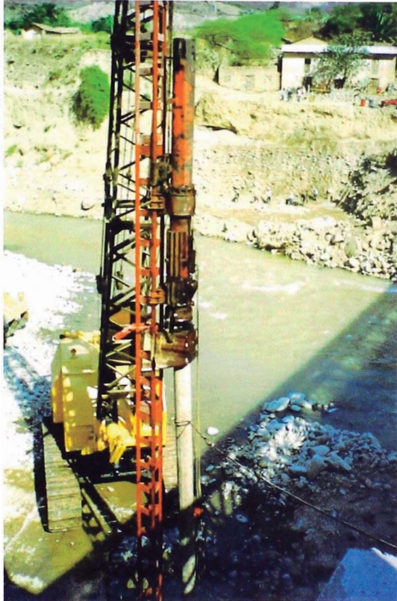
Foto N° 05: Proceso de hincado de pilotes sobre el lecho del río Chalhuanca. El equipo usado es una grúa LINK BELT de 25 toneladas la cual dispone de una columna de acero que sirve como guía; y un martillo DELMAG de 12 toneladas. El nivel de rechazo se acepta en 5 mm., por 10 golpes, alcanzando una profundidad mínima de 1.50 m. El falso puente consta de un sistema de 13 filas de pilotes de 04 hileras cada una, en total 52 pilotes.
