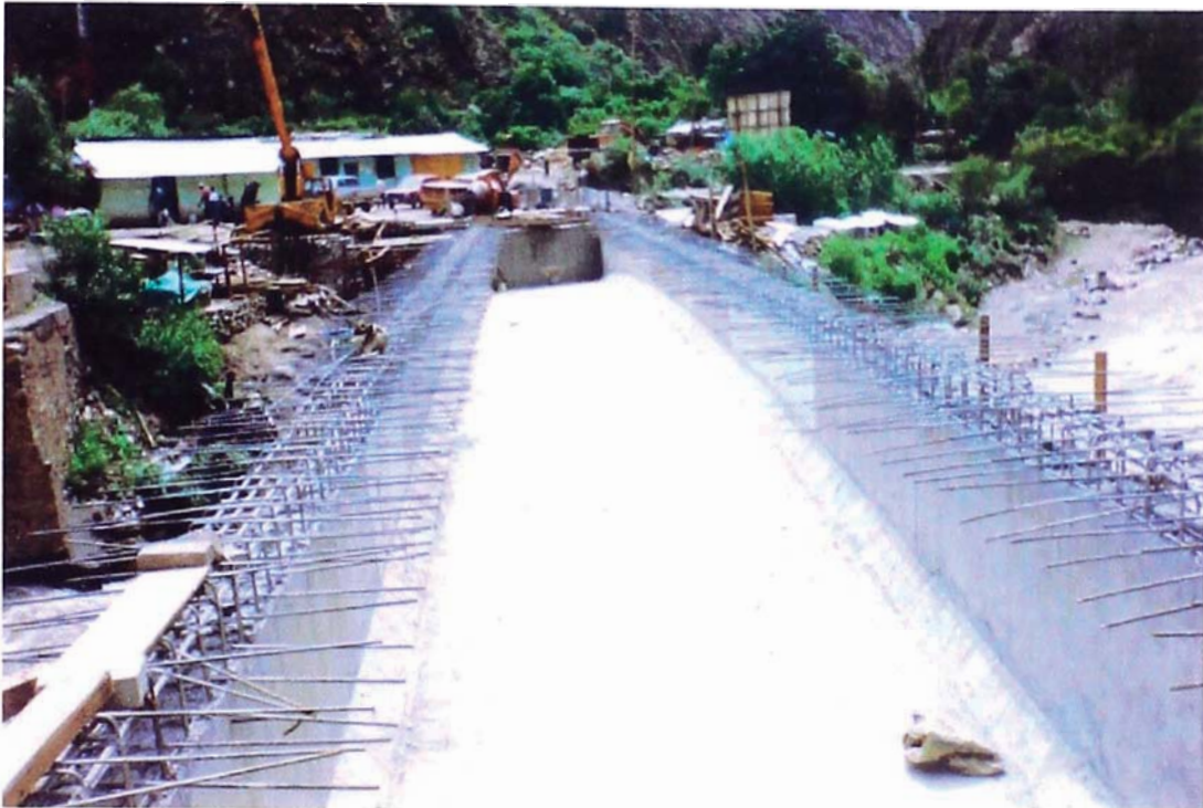
Foto N° 11: Las vigas y losa inferior se encuentran culminadas, se han dejado los empalmes de acero tipo V 401 @ 0.30 m para empalmar con los aceros de la losa superior.
