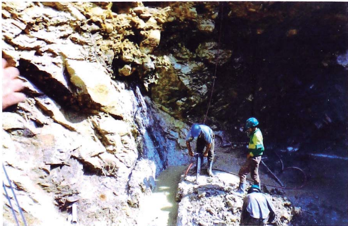
Foto N° 02: Vista de la cimentación izquierda, nótese la transición en el suelo de un conglomerado con bolonería a roca.
