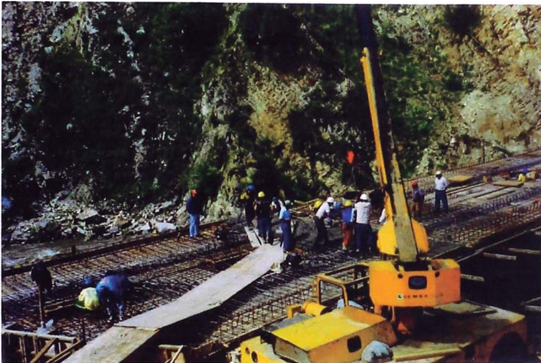
Foto N° 13: Colocación del concreto en la losa superior con apoyo de grúa de 4 toneladas, esto se realizó en tres etapas considerando los tercios de la longitud del puente.
