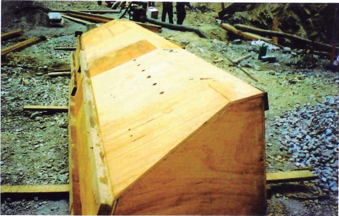
Foto N° 03: Detalle de encofrado de articulación; se puede apreciar la preparación de pasantes de acero \varnothing 3/4" del pie del pórtico.
