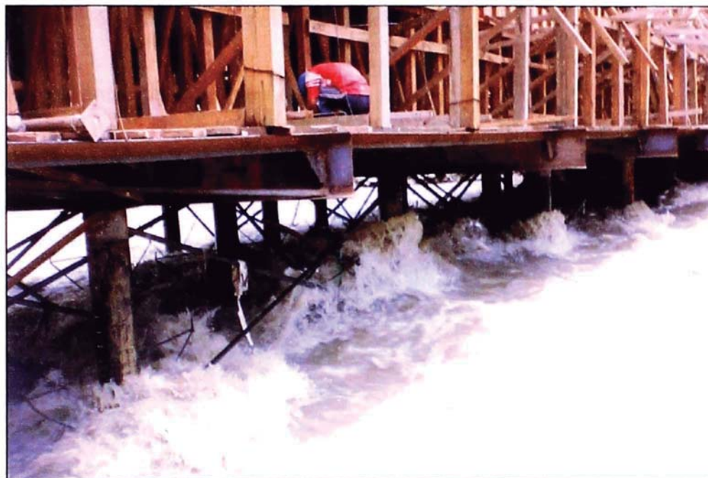
Figura N° 6. Donde se muestra el detalle de los materiales de arrastre atrapados por los arriostres del falso puente cuyo retraso de ejecución, devino en riesgo de afrontar los llenados de concreto en época de lluvias.
