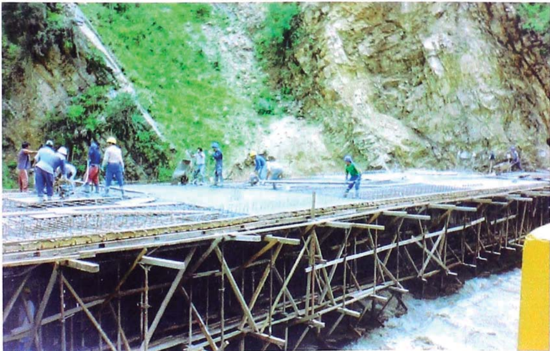
Foto N° 14: Se aprecia lo crítico del nivel de aguas que cruza por encima del nivel de falso puente, se adicionó en la mezcla Plastocrete para acelerar el proceso del fraguado inicial del concreto.
