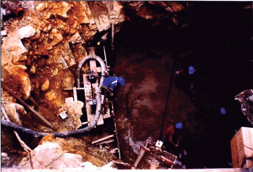
Figura Nº 4. Donde se muestra el llenado de concreto de la cimentación en el margen izquierdo, apreciamos el conglomerado con bolonería en la parte superior y el detalle del cambio geológico a roca maciza. Se puede complementar la información consultando la lámina CUI-A-1 adjunta y la lámina CUI-6/7 mostrada en la sección de Anexos.
