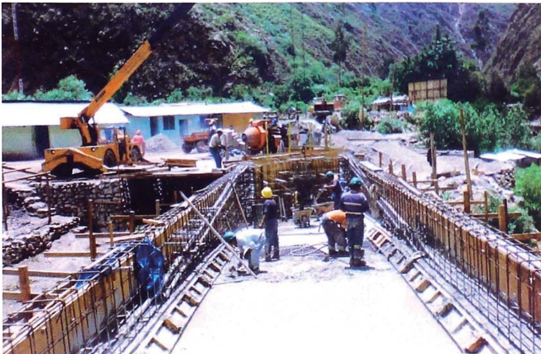
Foto N° 10: Colocación de concreto f'c 320 Kg/cm 2 hasta el nivel de ochavo de vigas, con apoyo de una grúa de 4 toneladas. Se aprecian los ductos del sistema postensado.
