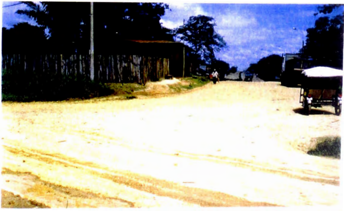
Empalme de cinturón asfáltico a Carretera de Quebrada del Manantay, vista desde esta última.
