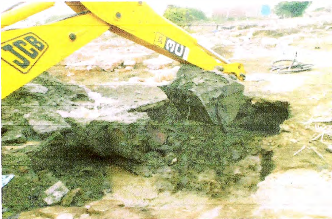
Foto 7; Excavación contigua a la avenida Alfonso Ugarte, observándose la inestabilidad del terreno conformado por la arena saturada.
