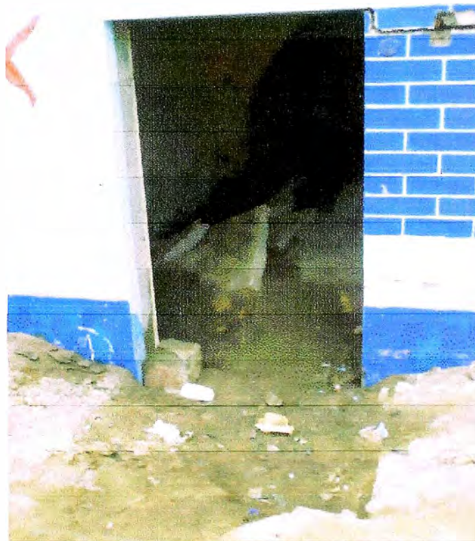
Foto 8; Asentamiento de la cimentación de una casa contigua a la avenida Alfonso Ugarte. Notar que también la losa fallo posiblemente a la disipación de presión de poros durante el sismo.
