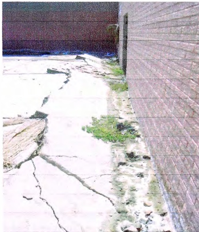
Foto 4; La losa del piso se encuentra levantada y agrietada debido al asentamiento diferencial por la licuación del suelo de cimentación. Cabe notar la presencia de sales en la tierra indicando presencia de agua.
