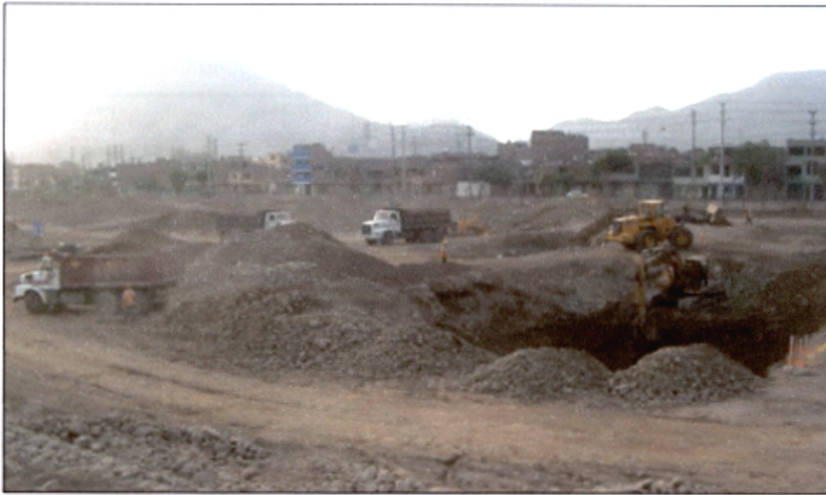
Foto 1.2. Excavaciones masivas en el proyecto los parques de El Agustino – Conjunto Residencial, fuente GyM
