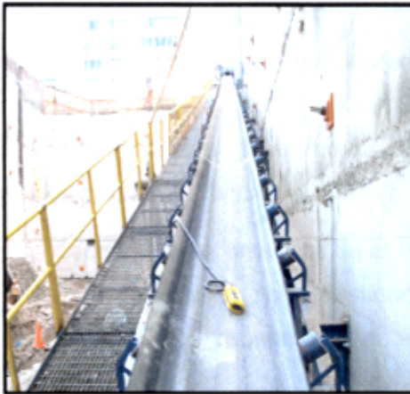
Foto 1.22 Utilización de baranda de protección
