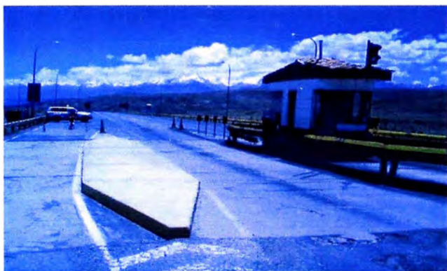
Peaje de Catac, se observa el estado deteriorado de la vía
