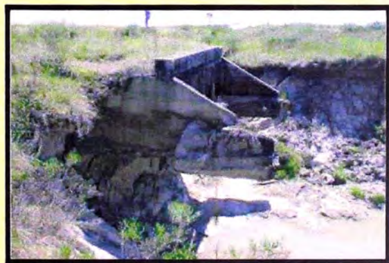
Rotura y falta de terraplén
