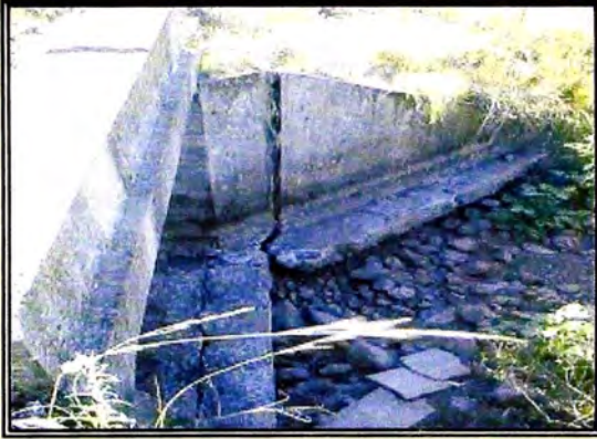
Rotura de ala
