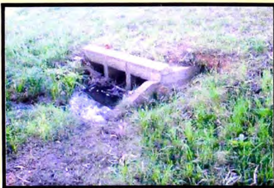
Falta de Terraplén
