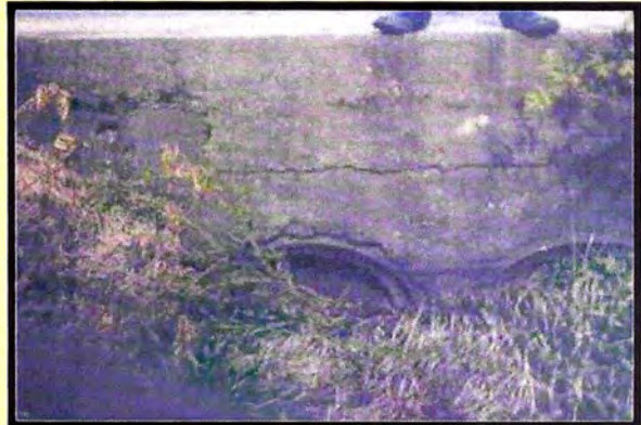
Fisuras en Murete
