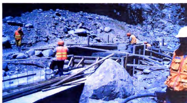
Construcción de un muro de contención en la parte donde se produjo la socavación
