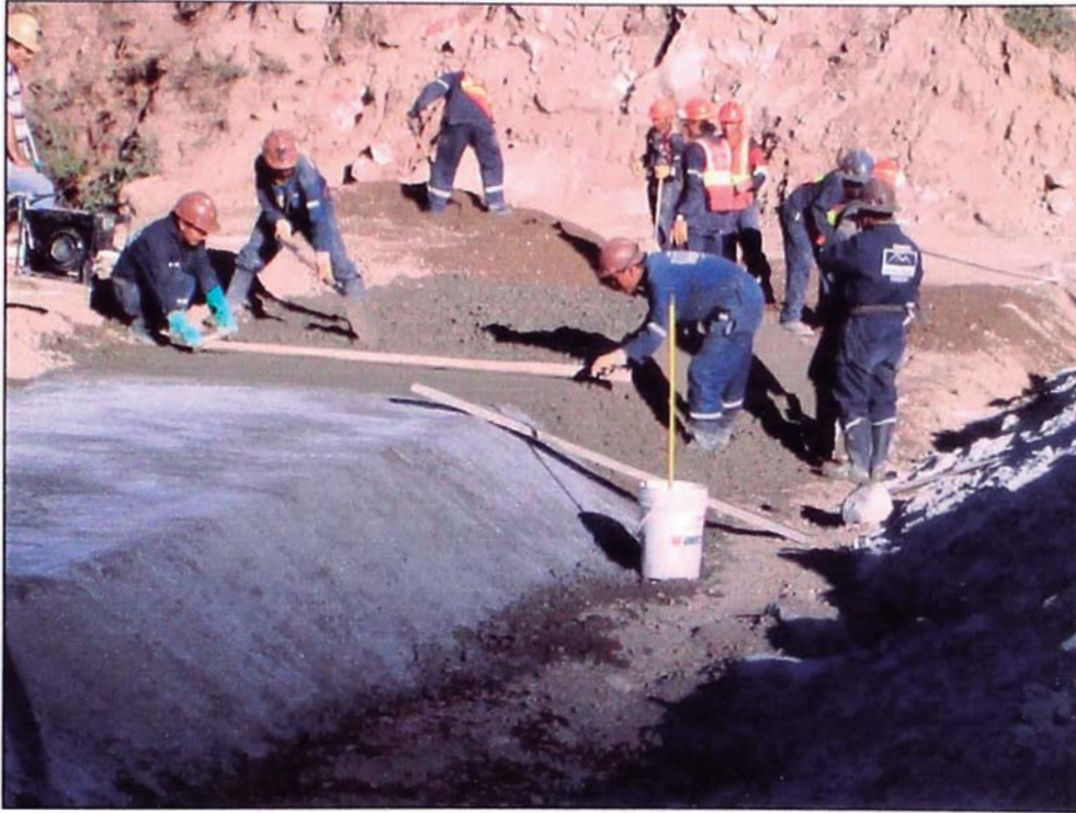
FOTO 23. Colocación manual de la base para el concreto extrudado, el cual es parte del espaldon de la presa aguas arriba.
