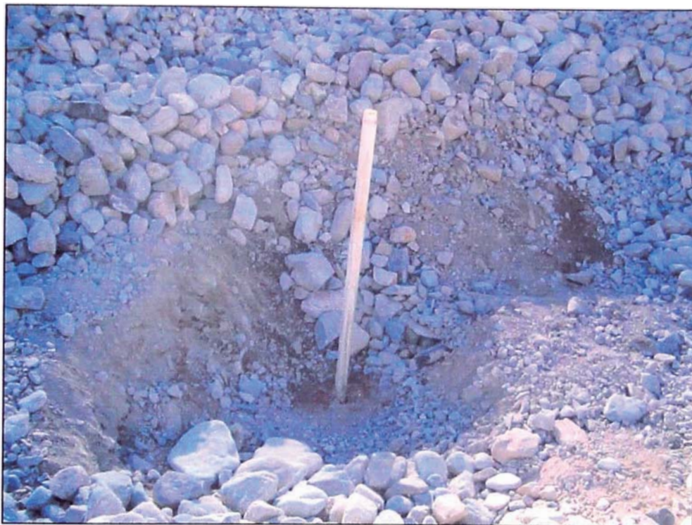
FOTO 27. En la conformación de las capas se tenía mucho cuidado en la conservación de los piezómetros.
