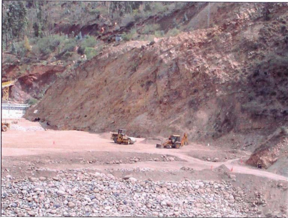
FOTO 7. EL Rodillo Compacta la capa de grava puesta, la pequeña retroexcavadora tiene la función de colocar el filtro, dren y Rip Rap.
