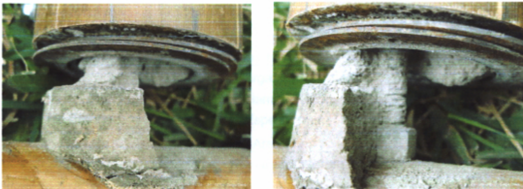
Fotografía N°.4.43 y N°.4.44: Falla del mortero y poca adherencia con el perno interior.
