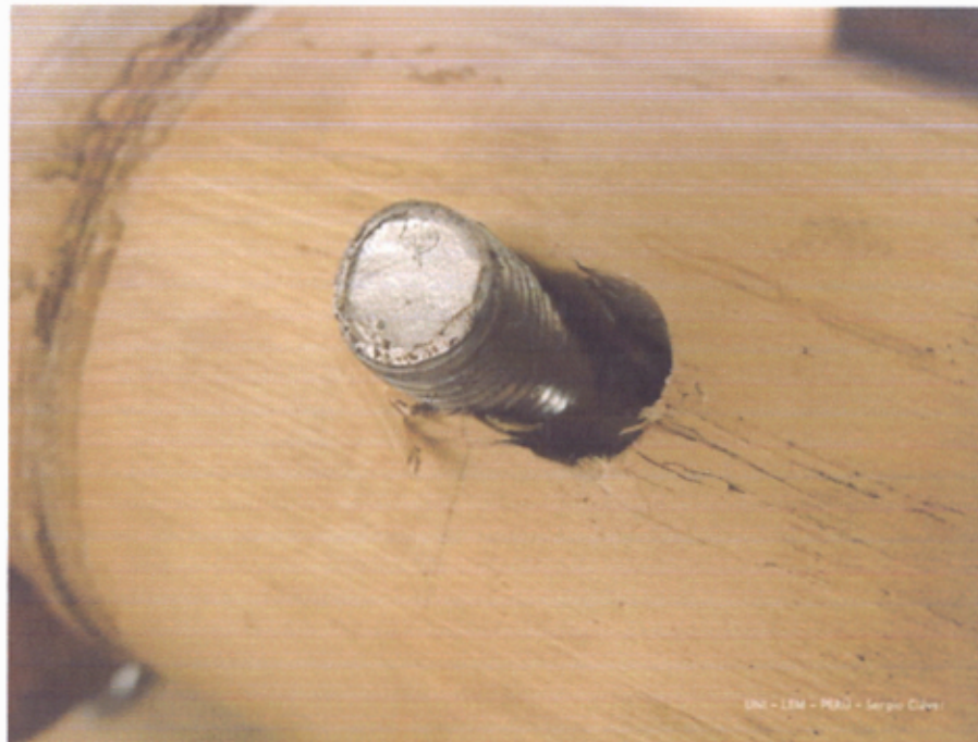
Fotografía N°.4.16: Desplazamiento de pernos.
