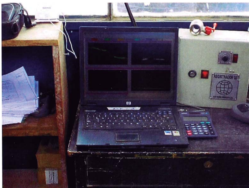
Foto 19: Regulador de Voltaje tipo dial (regula velocidad/RPM) de la bomba de inyección y Computadora de campo para la dirección y monitoreo en tiempo real del proceso de inyección.
