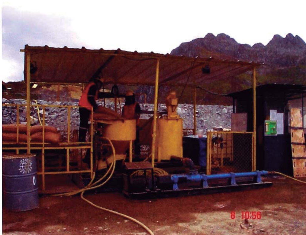
Foto 16: Planta de Inyección, comprende mezcladora coloidal Atlas Copco Cemix 402, agitador Cemag 401 y bomba de cavidad progresiva.
