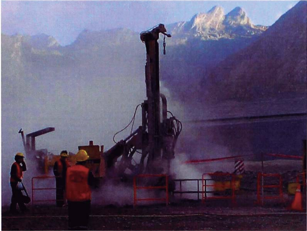
Foto 12: Perforadora Atlas Copco Mustang A-66 CB, perforación del taladro de inyección desde la plataforma de trabajo "Espigón" en el estribo derecho.
