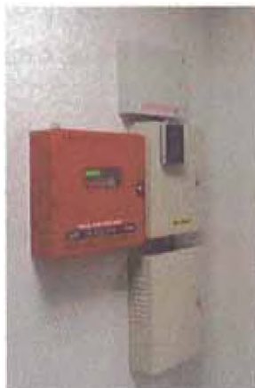
Fig.2.1 Central de alarmas
