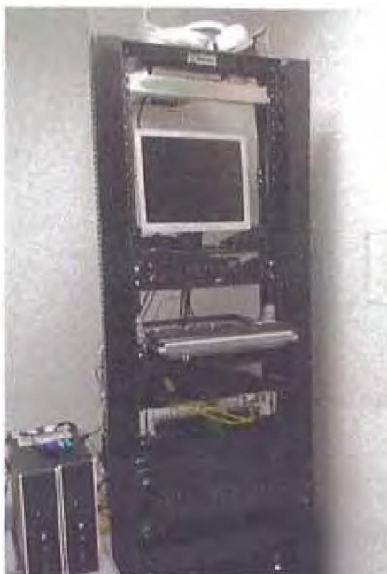
Fig.2.2 Rack de comunicaciones
