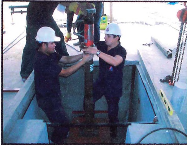
Figura 4.14. Instalación del gato hidráulico vertical y el soporte de extensión (tubo metálico).
