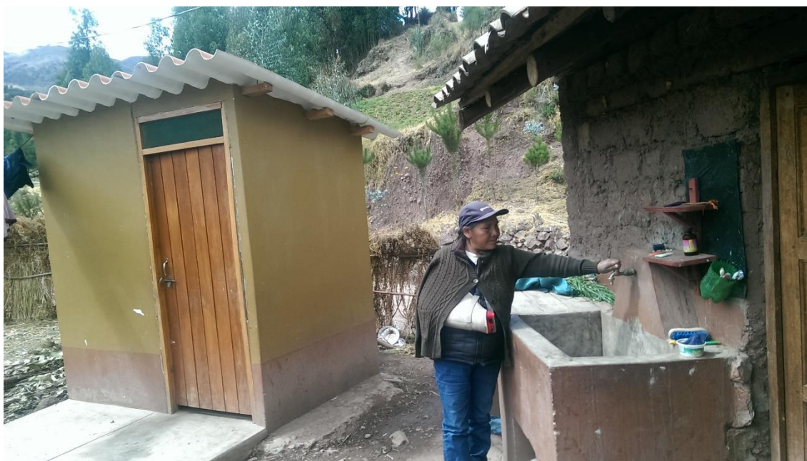
Foto N° 01: Unidad Básica de Saneamiento (Baño) y conexión de agua potable en la comunidad de Ampay
