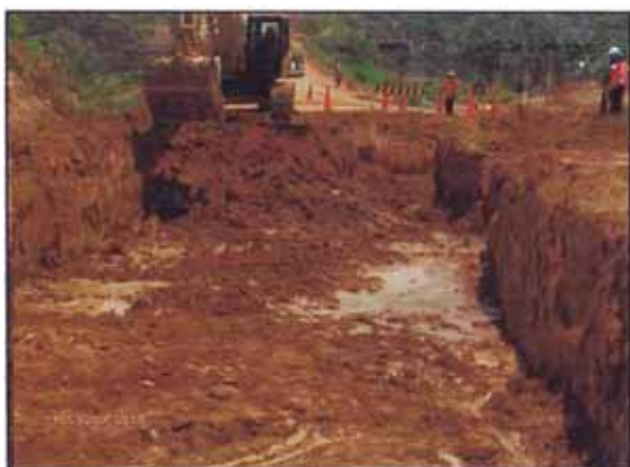
Foto 02. Zona de mejoramiento, el material presenta un estado de consistencia semi-líquido.
