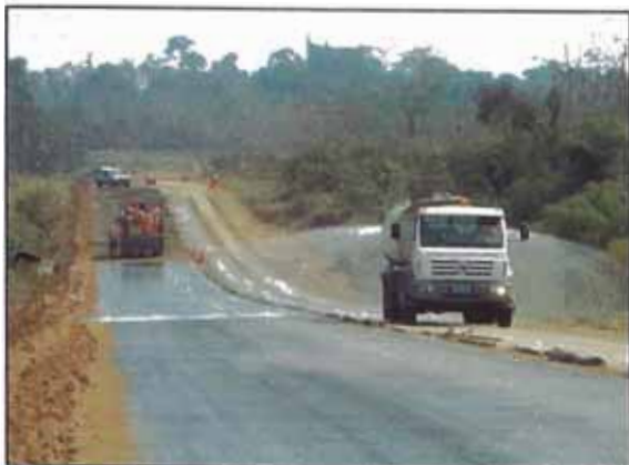
Foto 47. Curado con agua (riego niebla) mediante el camión cisterna en la base suelo cemento imprimada, por el método de aspersión.
