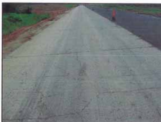
Foto 19. Fisuras por retracción hidráulica en la capa de base suelo cemento imprimado.
