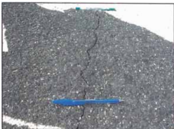
Foto 36. Fisura transversal de severidad media, a nivel de TSB.
