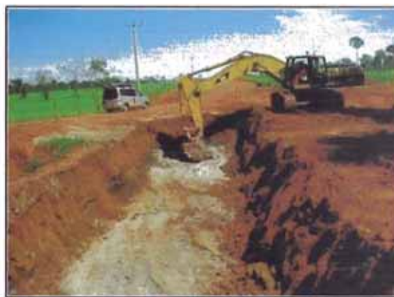
Foto 03. Extracción del material inadecuado a 1.50 m por debajo de la plataforma existente, material tipo CL, A-6 (8).
