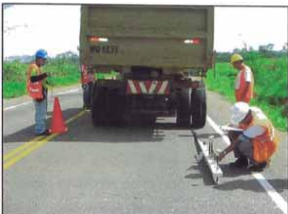
Foto 39. Mediciones de deflexiones con el equipo de Viga Benkelman en los sectores de monitoreo, sector km 694.
