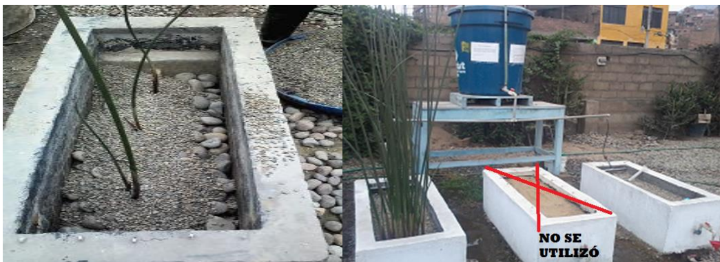
Figura 40 Instalación del sistema experimental en la primera etapa
