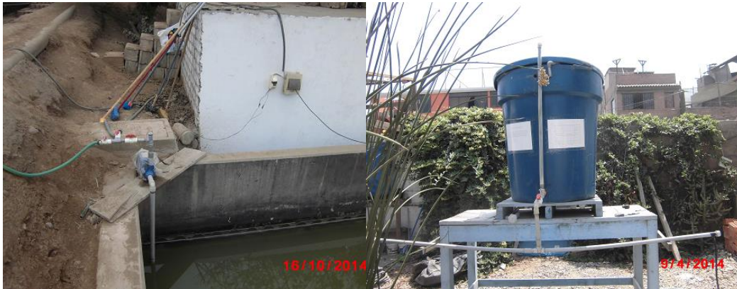
Figura 43 Bombeo del afluente hasta el tanque de almacenamiento
