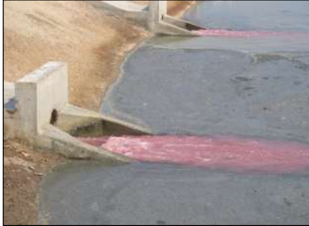
Figura 3.3. PTAR Ventanilla (Fuente: ANEPSSA)
