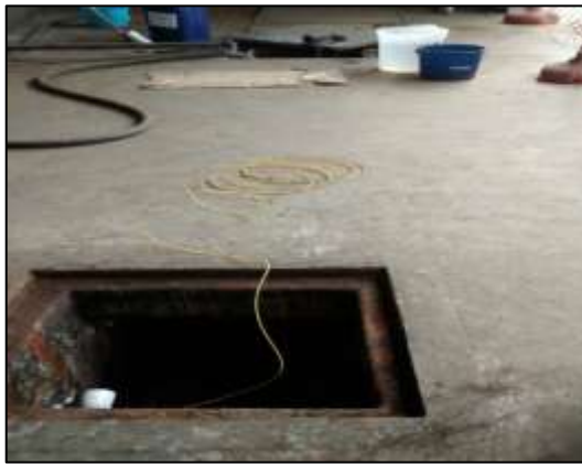
Figura 5.1. Tanque Homgenizador punto de toma de muestra.
