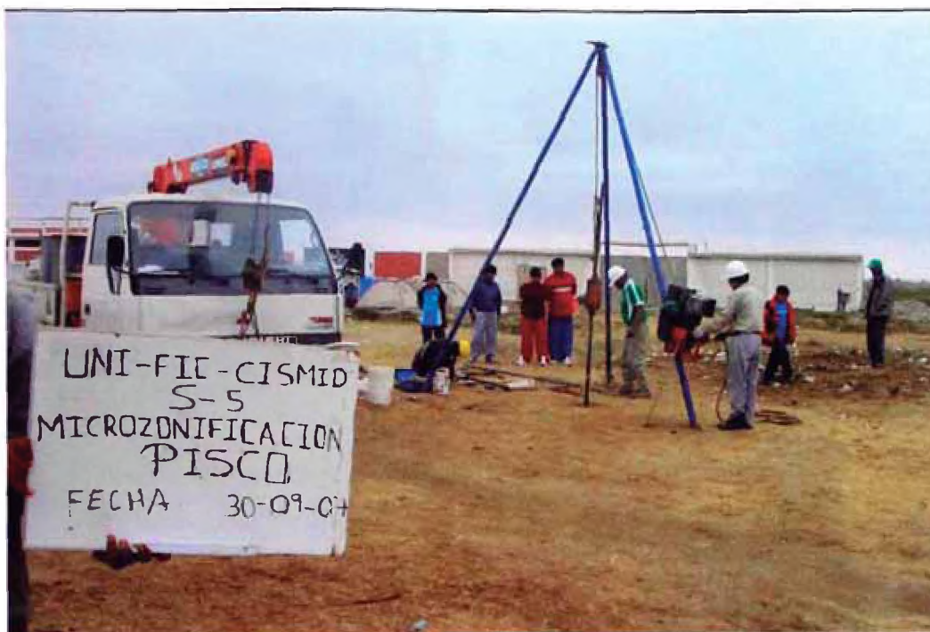
Fotografía No. 5. Ubicación del Sondaje S-5, frente al Estadio de San Andrés.
