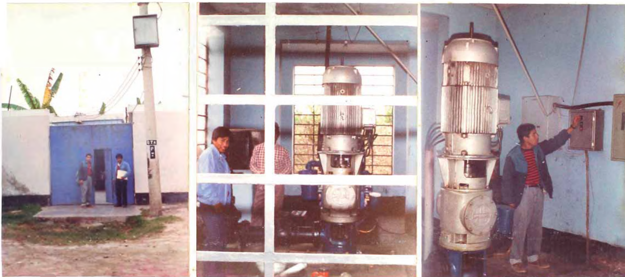
ESTACION DE BOMBEO ACTUAL
