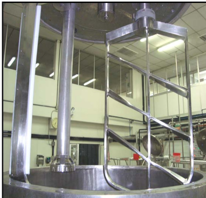
Figura 12: Agitador planetario, paleta rastradora y homogenizador
