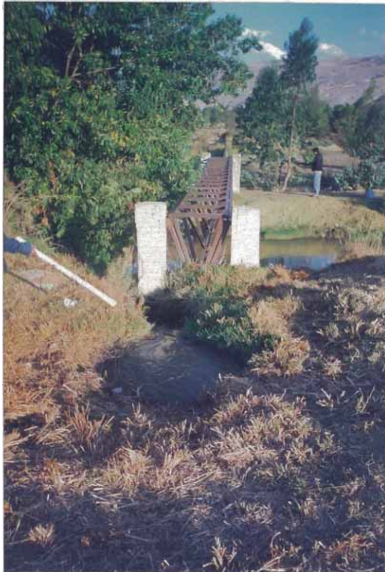
Buzón del emisor N o 1 Los desagües domésticos descargan al canal de irrigación.
