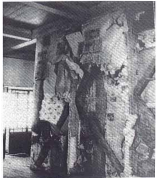
JIMENEZ: Lesiones ambientes interiores pre - restauración Fuente: Fototeca Personal Arq. José Correa, 2000.
