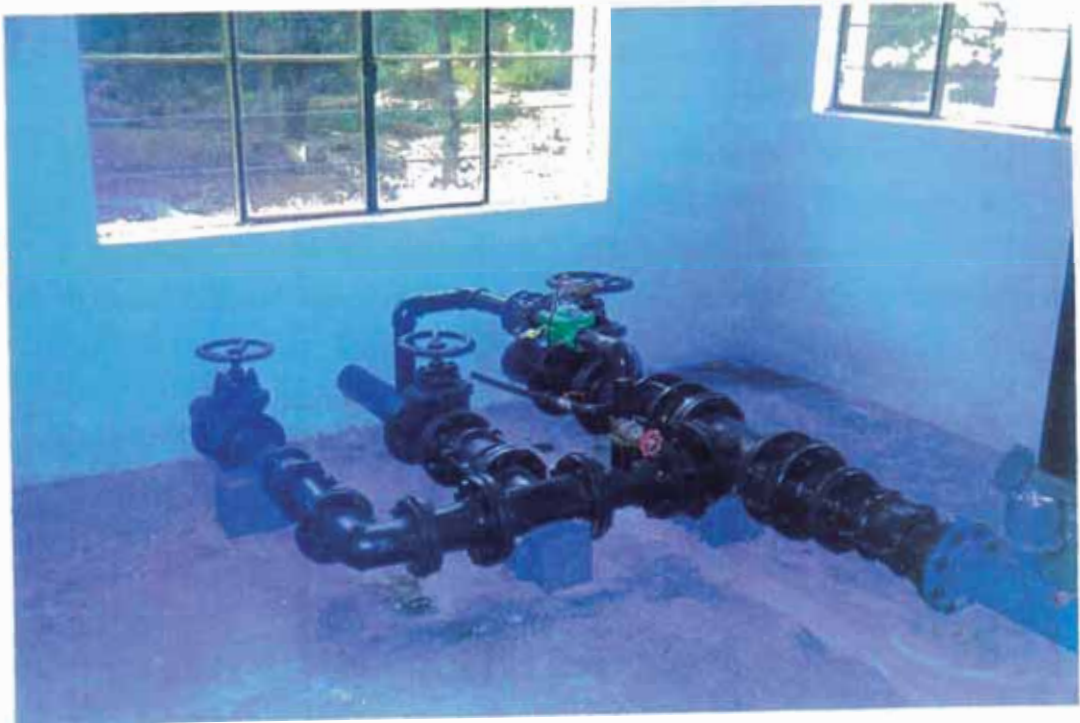
INSTALACIONES HIDRÁULICAS DE LA CASETA DE BOMBEO DEL POZO CAJUCA Nº1
