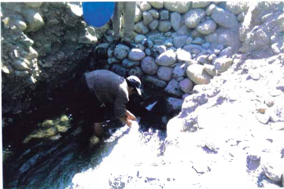
EXTREMO INFERIOR DE LA TUBERÍA DE SALIDA CON DESCARGA DEL AGUA PRODUCIDA POR LA GALERÍA FILTRANTE - RÍO AJA
