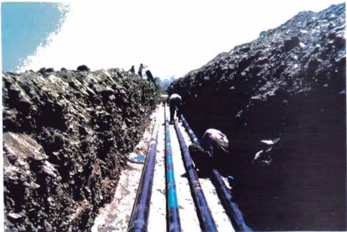
INSTALACIÓN DE TUBERÍA DE CONDUCCIÓN DE IMPULSIÓN DE LOS POZOS CAJUCA 1, CAJUCA 2 Y CAJUCA 3 Y TUBERÍA DE CONDUCCIÓN DE LA CÁMARA DE REUNIÓN DE CAJUCA
