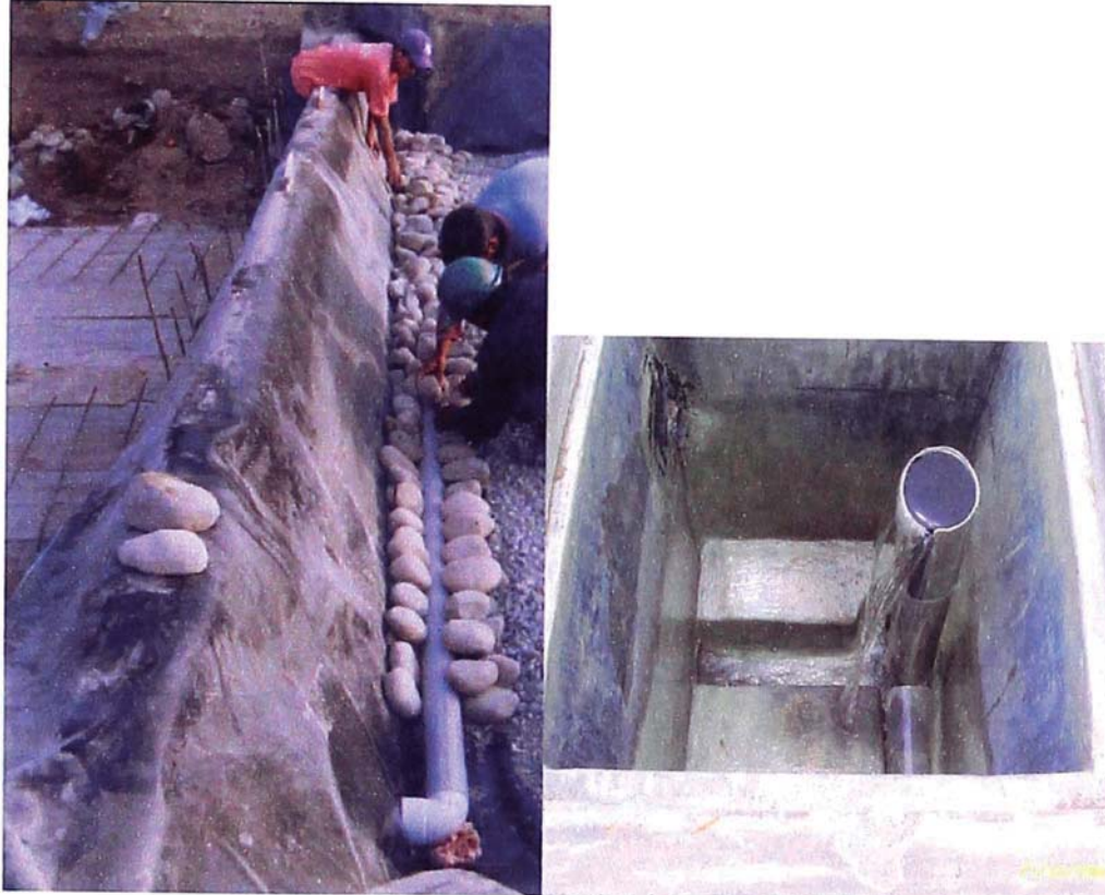
Foto 4.6: Estructura de recolección y Control de nivel de agua en Humedal
