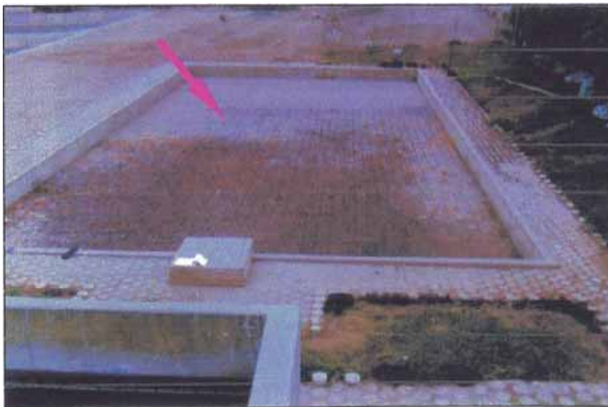
Foto 7.2. Lecho de secado de lodos de UNI-TRAR. Se muestra el sistema de drenaje en el fondo por donde filtrará el agua del lodo hacia el sistema de alcantarillado.
