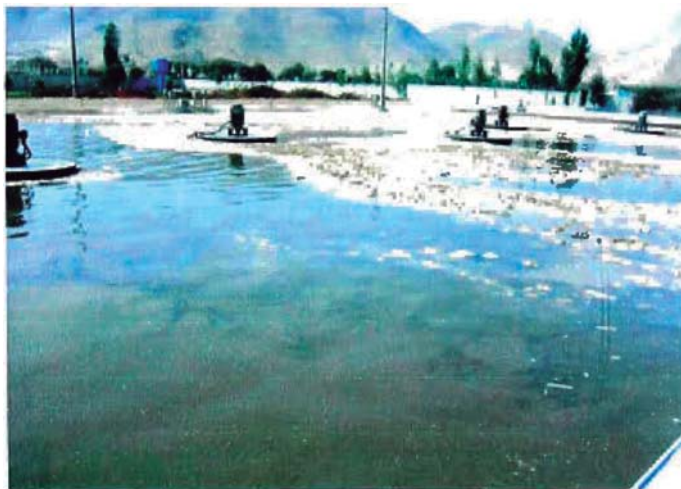
FIGURA 5.- VISTA DE LOS TANQUE DE AIREACIÓN
