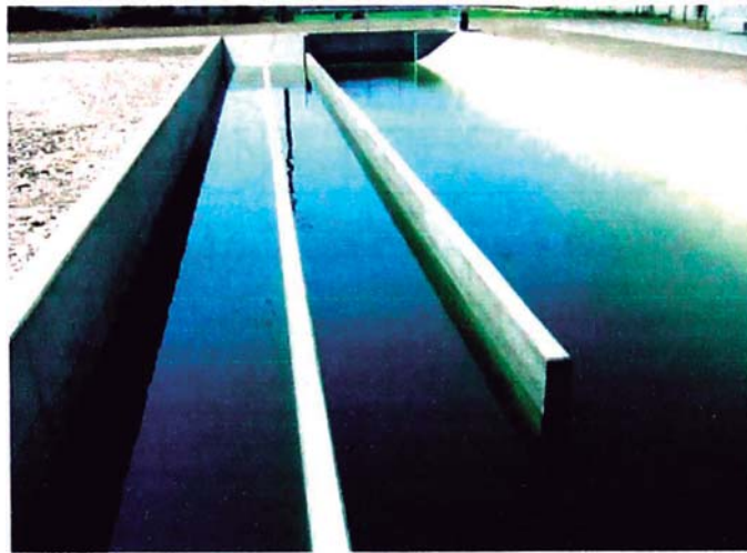
FIGURA 6.- VISTA DE LA CAMARA DE CONTACTO
