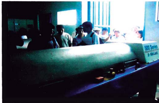
FIGURA 11.- VISTA CENTRIFUGA INSTALADA EN LA PTAR DE PUENTE PIEDRA
